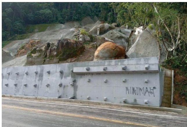
Foto 2 – Obra de contenção de encosta em região de serra. Processo: escorregamento decorrente de chuvas intensas (verão 2021), em encosta em solos residuais e com presença de blocos de rochas gnáissicas (alterada mole e alterada dura). Impacto: paralização de um dia nas duas pistas da rodovia e por um ano em uma das pistas. Obras: limpeza, retaludamento, ancoragem dos blocos com chumbadores e cortina atirantada, serviços ainda em andamento (2024). Rodovia Mario Covas, km 7 (Rio – Santos), Ubatuba, SP, em junho de 2024. Legenda e foto (2024): João Jeronimo Monticelli.
