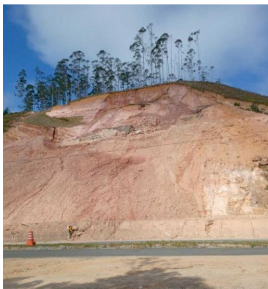
Foto 3 – Escorregamento de encosta em área de morros. Processo: deslizamento em cunha decorrente de chuvas intensas (verão 2021), em encosta em solo de alteração de filito. Impacto: paralização de um dia nas duas pistas da rodovia. Obras: construção de pista para contorno, retirada do material depositado na pista. Não há obras de proteção (contenção) da encosta. (julho/2014). Rodovia Osvaldo Cruz, km 65, São Luís do Paraitinga, SP. Legenda e foto (2024): João Jeronimo Monticelli
