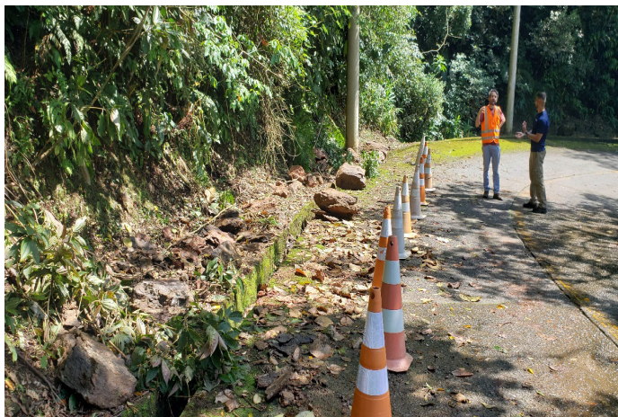
Ponto P-01 – Ocorrência de blocos rolados oriundos de um deslizamento translacional raso de solo/rocha e isolamento da área com cones.
