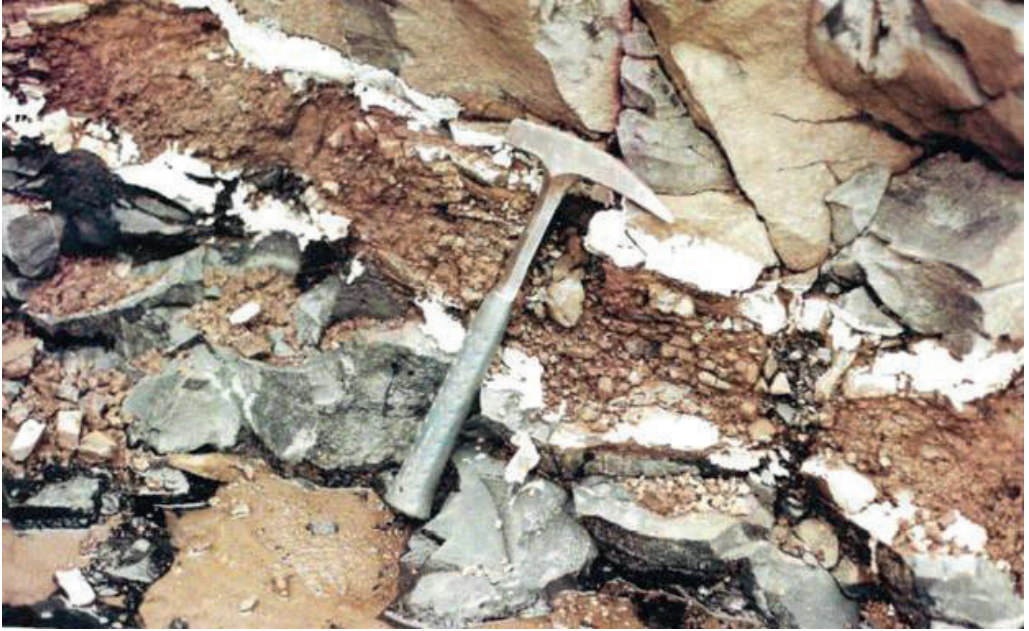
Figura 11.1.2.2 - Água Vermelha - Aspecto da junta-falha da el. 305 m, na fundação das estruturas de concreto (Fujimura, ABGE, 2017, pág. 255).
