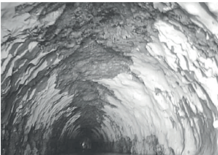
Figura 11.13.3 - Itá - O deslocamento de rocha se concentrou na abóbada dos túneis, configurando capelas (Mafra & Araújo, 2003).
