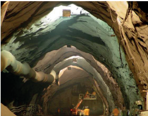
Figura 11.21.2 - Monte Claro - A forma final da seção do túnel reflete a ocorrência do fenômeno de descompressão (Nieble, 2006).
