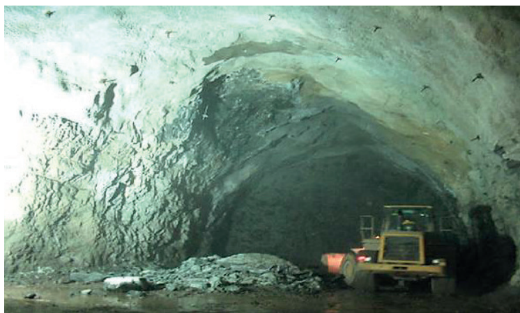
Figura 11.8.3 - Castro Alves - Manifestação de decompressão com formação de capelas na abóbada do túnel (Souza, 2005).
