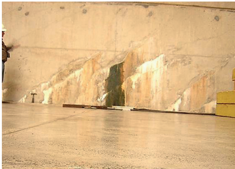
Figura 11.23.6 - Nova Ponte - Trincas na parede lateral direita da casa de força na el. 704,50 m (Brito, S. - Comunicação pessoal).
