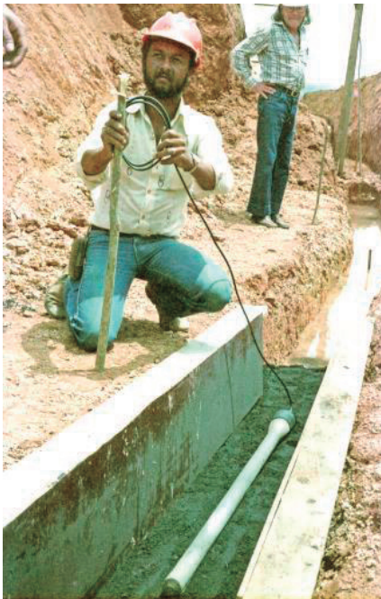
Figura B7 - Instalação de barra de aço-silício no meio de valeta com carvão, no fundo da escavação do eletrodo de corrente contínua, em Ibiúna, São Paulo.
