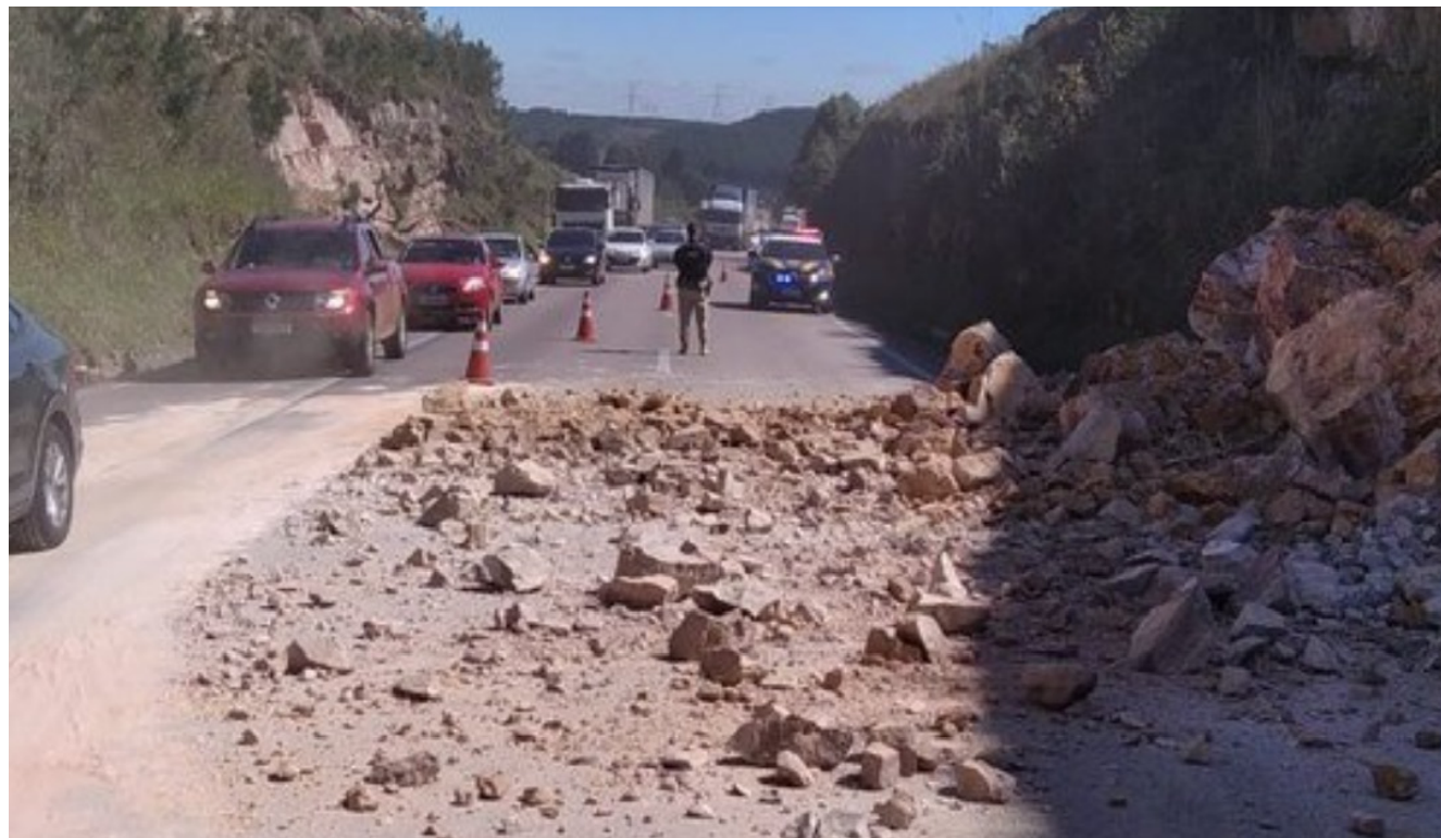
Figura 2. Aspecto da pista da BR 277 com fragmentos de rocha deslocados do talude de corte.
