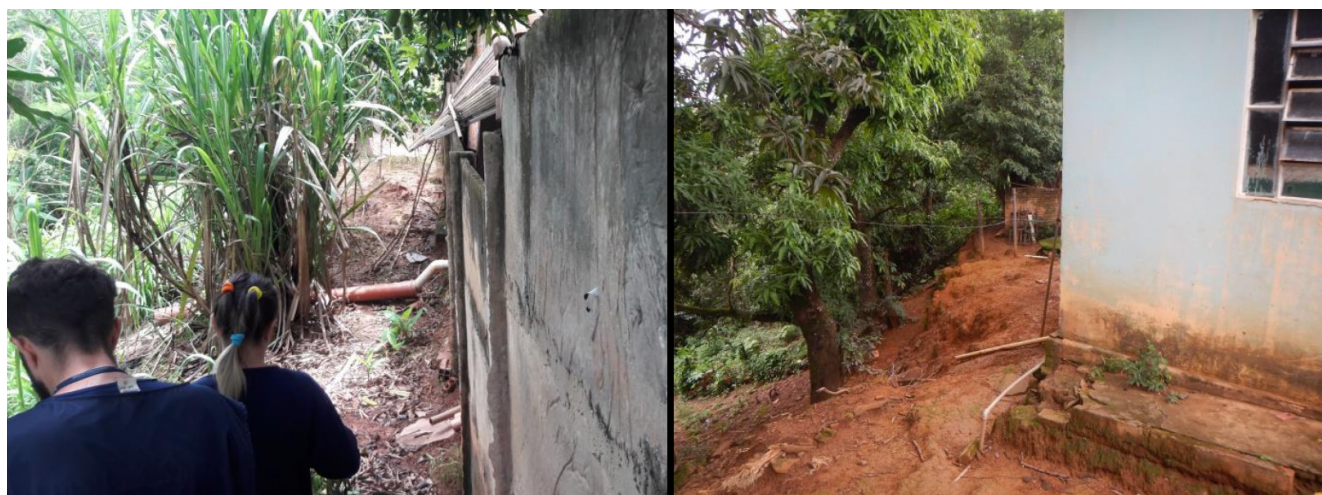
Figura 8. Residência próxima ao rebordo erosivo, com lançamento de água servida, e residência próxima a erosão ativa, Silvânia 2017 (Fernandes et al, 2017).
