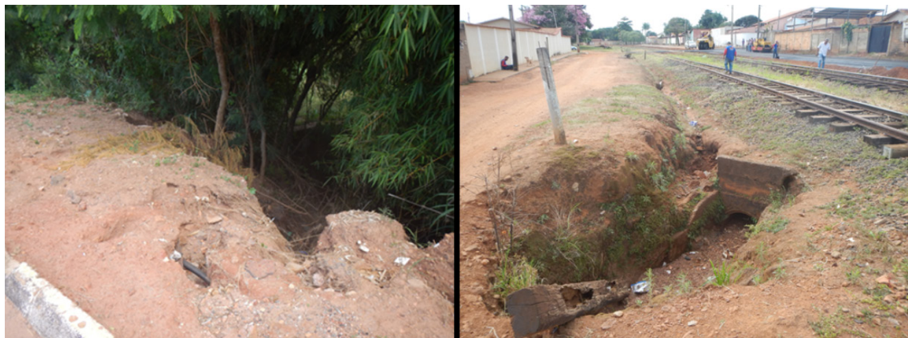
Figura 2. A- Local de pequena erosão próximo ao lago de recreação da cidade de Bonfinópolis e, B- local de enxurrada ao lado da linha férrea, 2018 (Fernandes et al), 2018.
