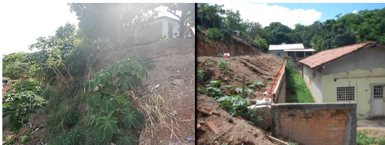
Figura 20. Local de movimentação de solo devido a método construtivo de corte/aterro, com muro embarrigado na foto à direita, Barra do Garças, 2020 (Fernandes et al, 2020).
