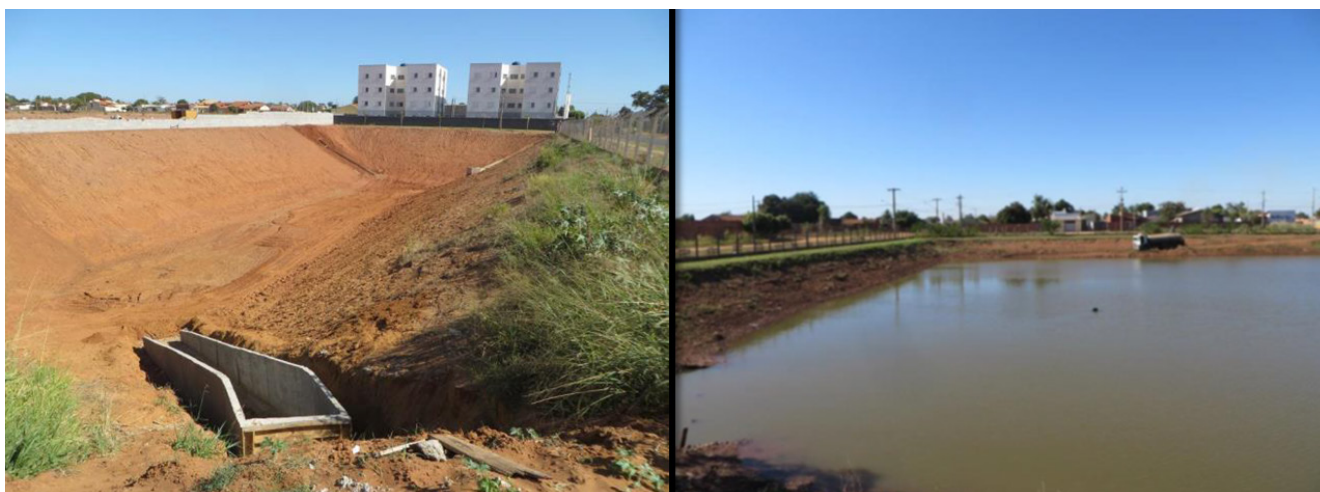
Figura 28. Bacia de contenção de águas pluviais e em operação, Três Lagoas, 2019 (Antoneli et al. 2019).
