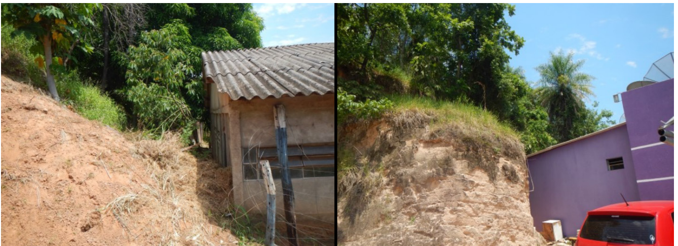
Figura 26. Exemplos de residências em área de risco de deslizamento planar em construção de corte-aterro, Camapuã, 2015 (Facuri et al. 2015).
