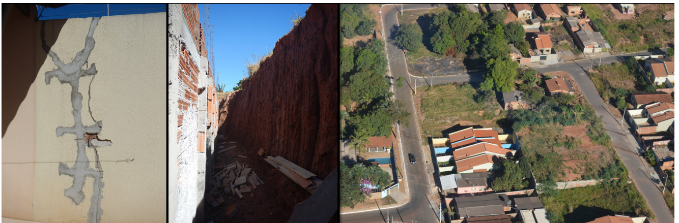
Figura 10. Erosão marginal ocasionando problemas a moradia próximas, Rua das Mangueiras, Setor Retiro dos Bosques, Aparecida de Goiânia, 2017 (Fernandes et al, 2017).
