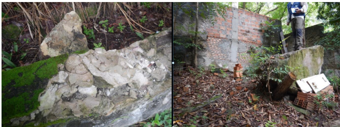
Figura 19. Local atingido por rolamento de bloco, Rua Rio Negro e Rua Purus, Barra do Garças, 2020 (Fernandes et al, 2020).
