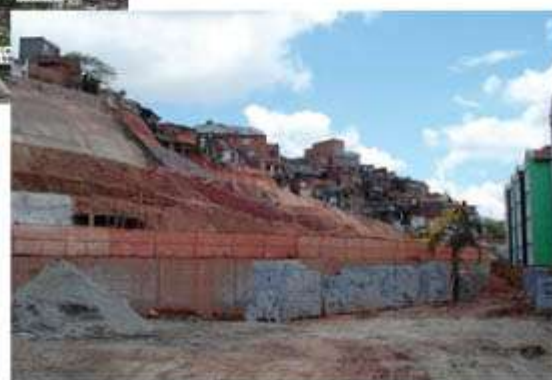
Exemplo de obra de contenção e reurbanização em execução na área Nova Jaguaré I, pertencente a Subprefeitura da Lapa
