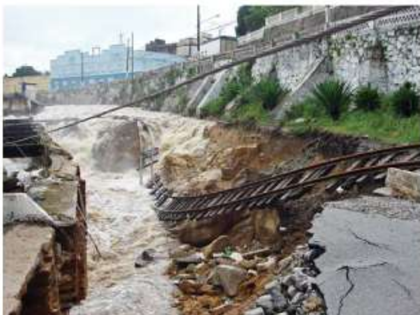
Rio Largo: via férrea e acesso rodoviário destruídos pelo rompimento da ombreira da barragem, com solapamento e erosão na margem esquerda do rio Mundaú, comprometendo as fundações das pilstras de sustentação da avenida
