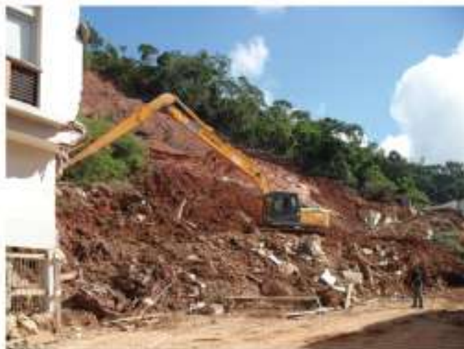
Escorregamento circular, localizado no centro da cidade de Nova Friburgo, o qual atingiu um prédio e diversas moradias - Arquivo IPT
