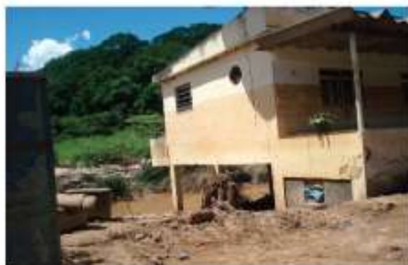
Nota a altura que as águas atingiram na moradia localizada na beira do rio, em São José do Vale do Rio Preto - Arquivo IPT
