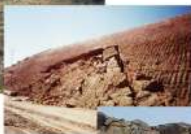
Escorregamento em cunha em talude de corte, durante as obras do Rodoanel. Foto: Leandro Cerri
