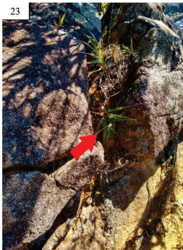
Figura 23. Crescimento de vegetação em fratura tectônica com abertura de cerca de 20 centímetros.
