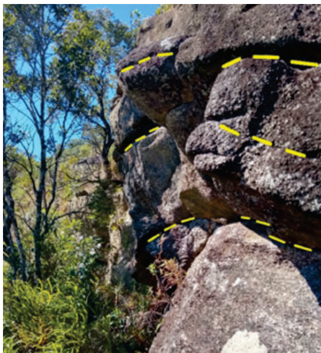
Figura 25. Fraturas de alívio sub-horizontais encontradas no topo da Pedra do Quitandinha.
