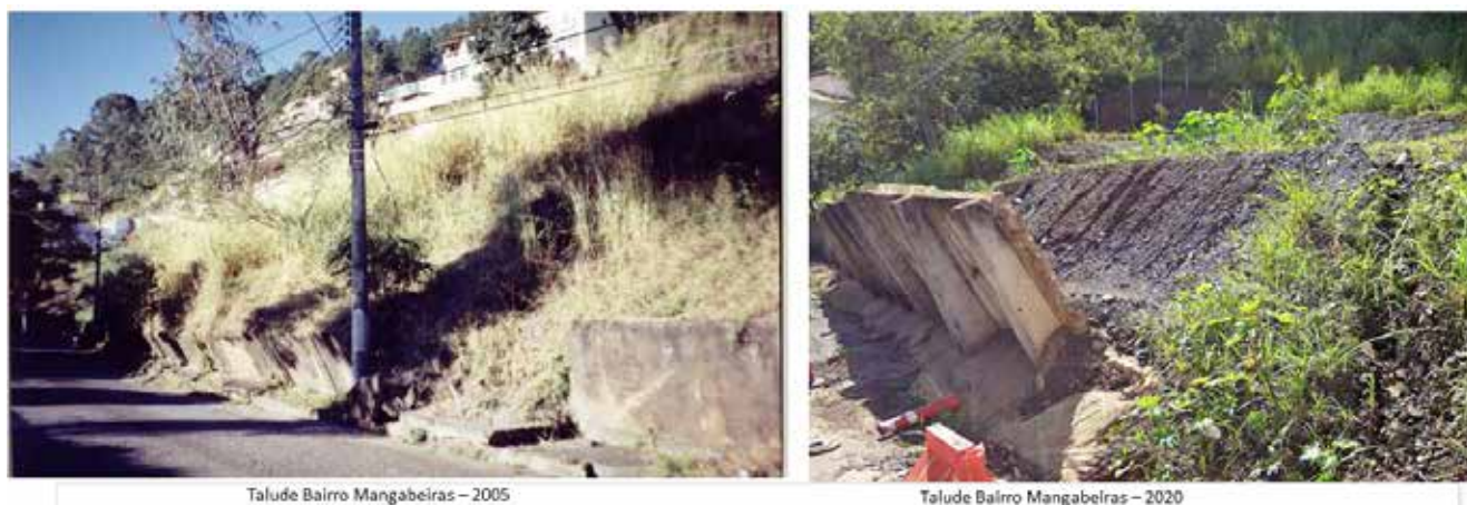
Figura 15. Rastejamento que ocorre em talude formado por tálus derivado da fragmentação de filitos e quartzitos da Formação Cercadinho no bairro Mangabeiras em Belo Horizonte.
