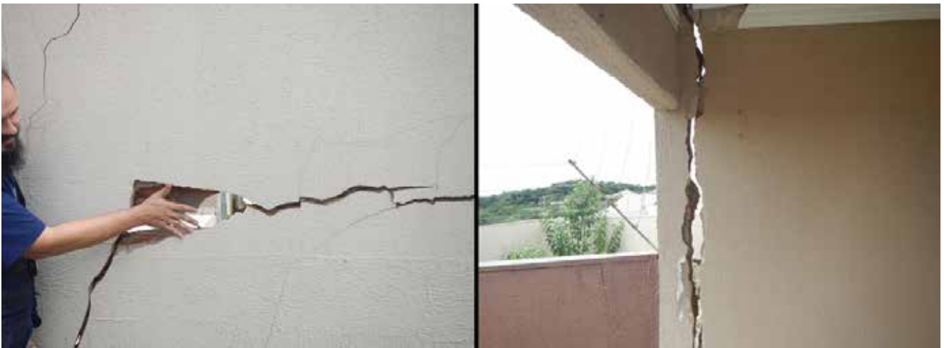
Figura 14. Local de movimentação de solo em situação de corte-aterro, Rua Doze, Bairro Morumbi, Anápolis, 2019 (Fernandes et al, 2019).
