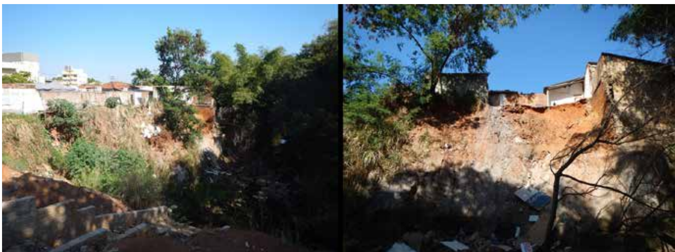
Figura 12. Erosão marginal atingindo residências, Jardim América, Goiânia, 2016 (Fernandes et al, 2016).
