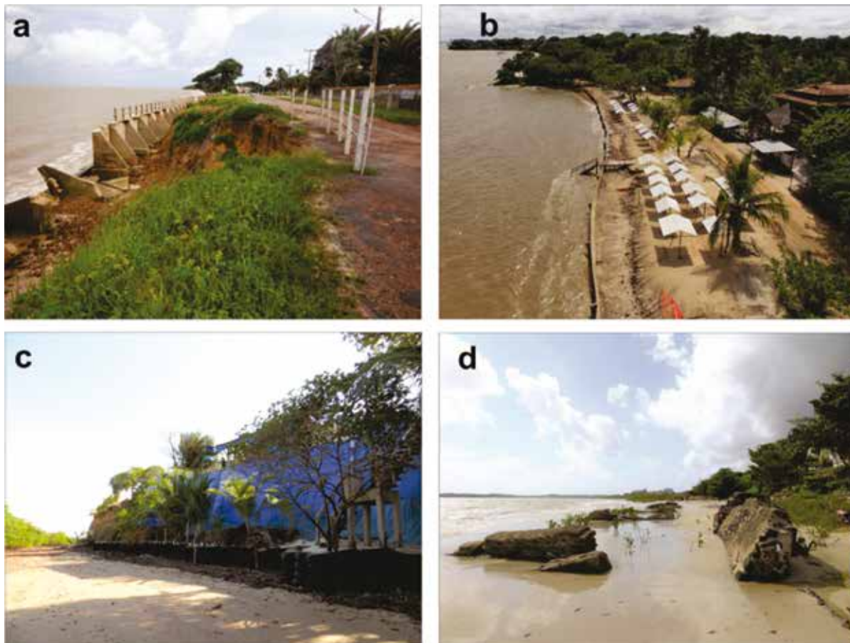
Figura 6. a: Muro de arrimo destruído pela erosão costeira na orla da cidade de Salvaterra, Fonte: Melo & Simões (2016) b: Muro de arrimo embarrigado na Praia do Paraíso, Ilha de Mosqueiro (Belém), situação em 2018; c: Utilização de pneus na base da falésia, bem como o uso de lonas para impedir o recuo da falésia na Praia do Recreio (Marapanim), Fonte: Teixeira & Melo (2019); d: Ruínas de duas posições de muro de arrimo destruídos pela erosão costeira na Praia do Maçarico (Salinópolis), Fonte: Teixeira & Bandeira (2020).
