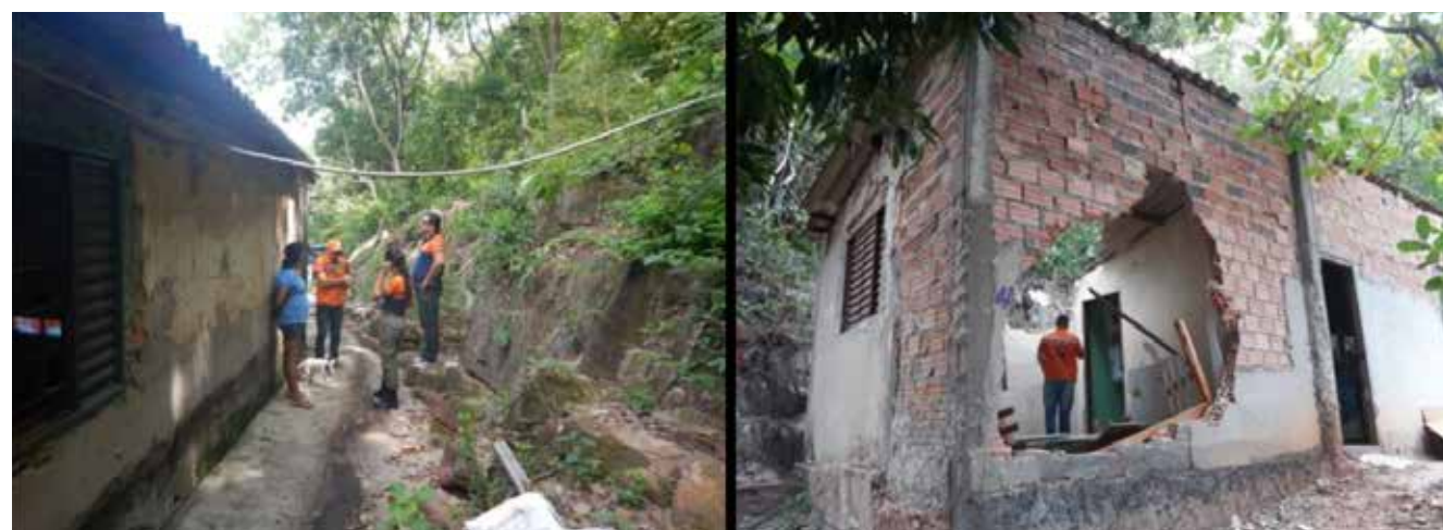
Figura 21. Local atingido por rolamento de blocos, mostrando residências próximas ao talude rochoso da Serra Azul, Barra do Garças, 2020 (Fernandes et al, 2020).
