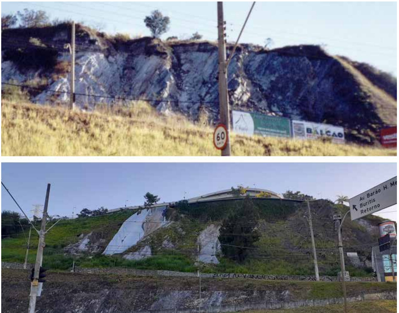
Figura 8. Ruptura em cunha seguida de ruptura planar, tombamento e fluxo de detritos em talude da Av, Raja Gabaglia em Belo Horizonte. A foto superior data de 2005 e a foto inferior data de 2021 após intervenções no local. Muro gabião foi feito na base do talude e um prédio foi construído na parte superior. As lonas ao longo da face indicam que as intervenções não foram eficazes e o talude continua em movimentação.
