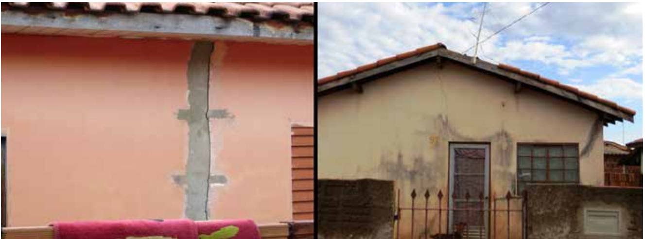
Figura 25. Moradias atingidas por recalque local, Bataguassu, 2013 (Vieira Junior et al, 2013).
