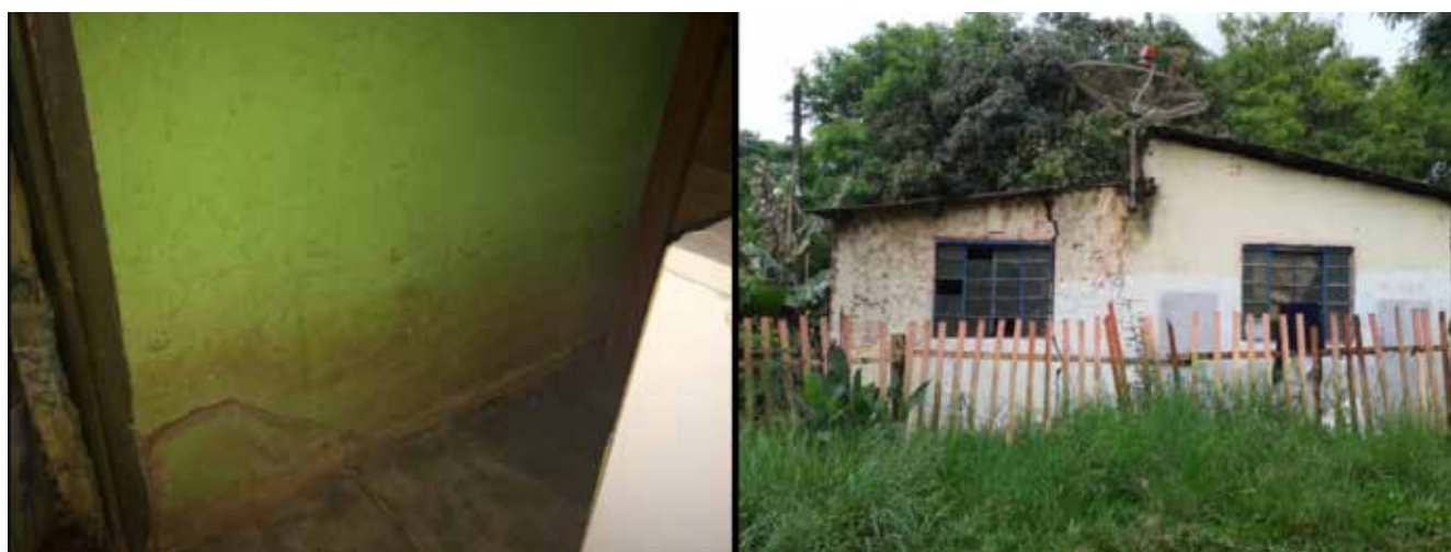
Figura 24. Residências atingidas por inundação, Ponta Porã, 2015(Lazareti et al, 2015).
