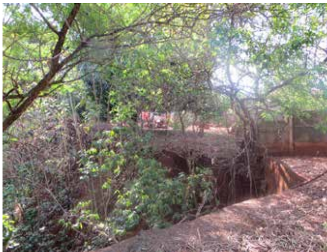
Figura 4. Local de atingimento por inundações na cidade de Quirinópolis, 2015 (Melo et al, 2015).
