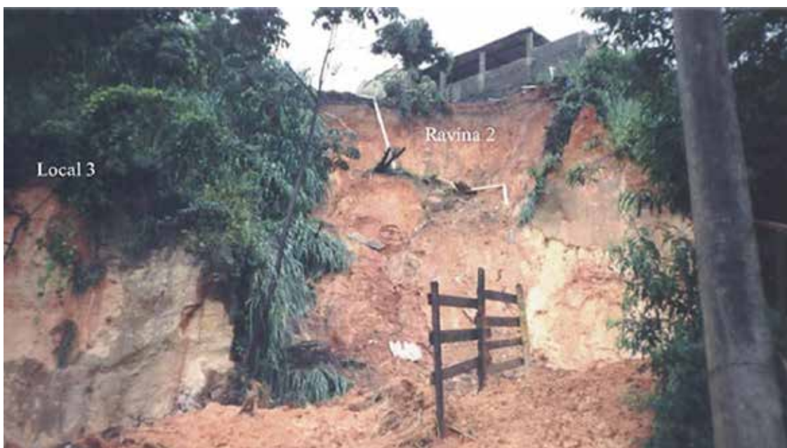
Figura 12. Imagem de escorregamento em solos residual de gnaiss no bairro Engenho Nogueira em Belo Horizonte.
