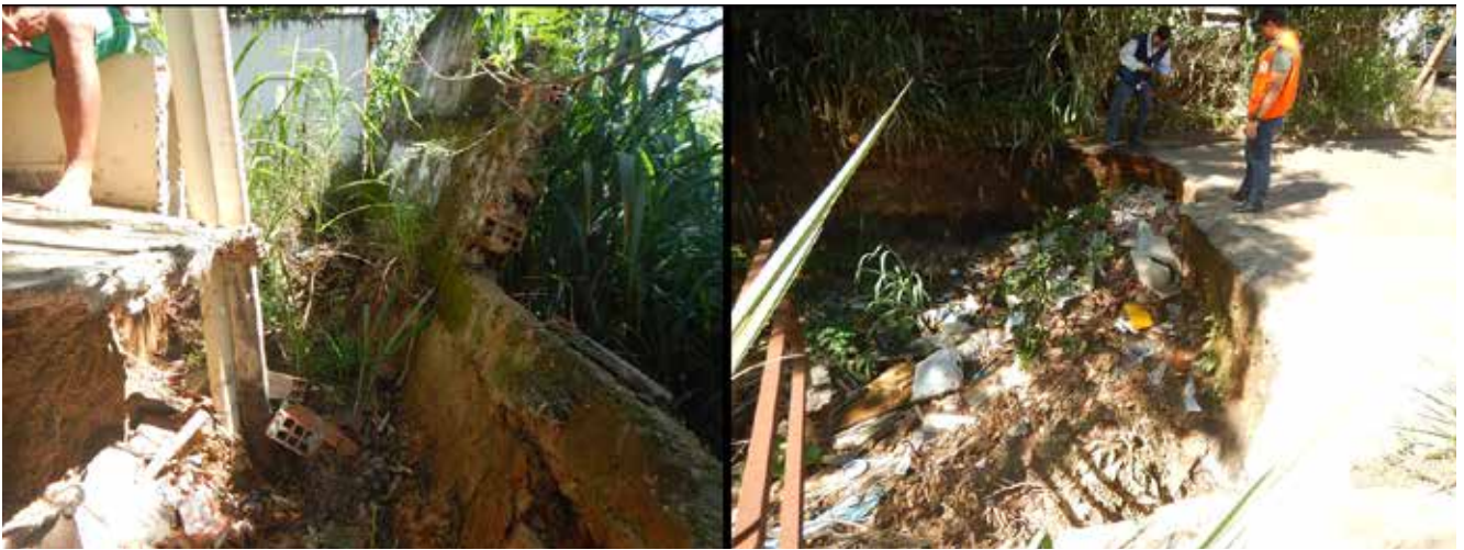
Figura 13. Erosão marginal atingindo residências, Ruas Padre Anchieta e Joaquim Sebastião, Bairro Santa Maria de Nazareth, Anápolis, 2019 (Fernandes et al, 2019).
