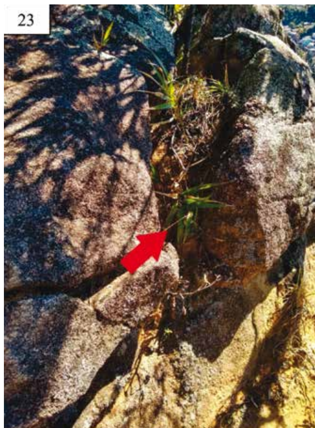
Figura 23. Crescimento de vegetação em fratura tectônica com abertura de cerca de 20 centímetros.
