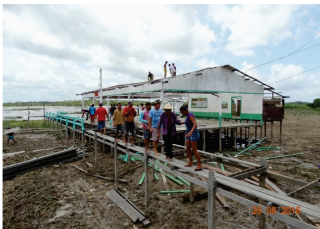
Figura 5. Casa de madeira, sobre palafitas, sendo desmontada, para que não seja mais ocupada, uma vez que apresenta risco muito alto de ser atingida pela erosão fluvial. Fonte: Pará (2016).
