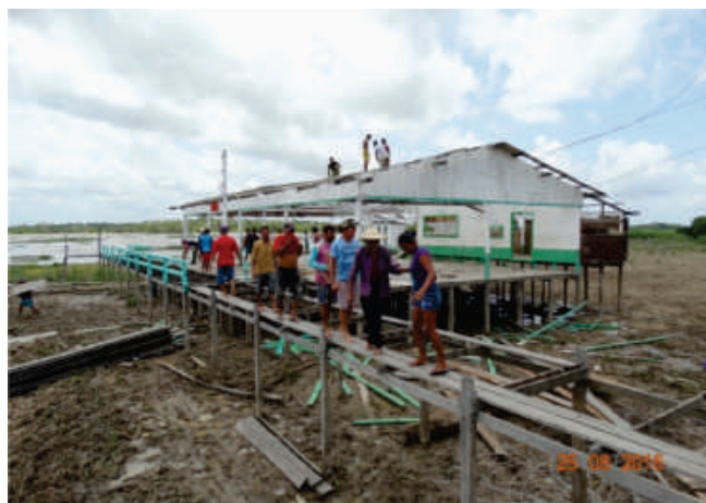
Figura 5. Casa de madeira, sobre palafitas, sendo desmontada, para que não seja mais ocupada, uma vez que apresenta risco muito alto de ser atingida pela erosão fluvial. Fonte: Pará (2016).
