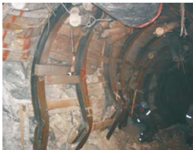
Figura 15 - Cambotas rígidas deformadas.
