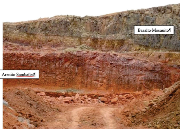
Figura 2. Talude de escavação para a implantação do circuito de adução e geração da usina mostrando o contato entre o Arenito Sambaíba (base) e o Basalto Mosquito (topo)
