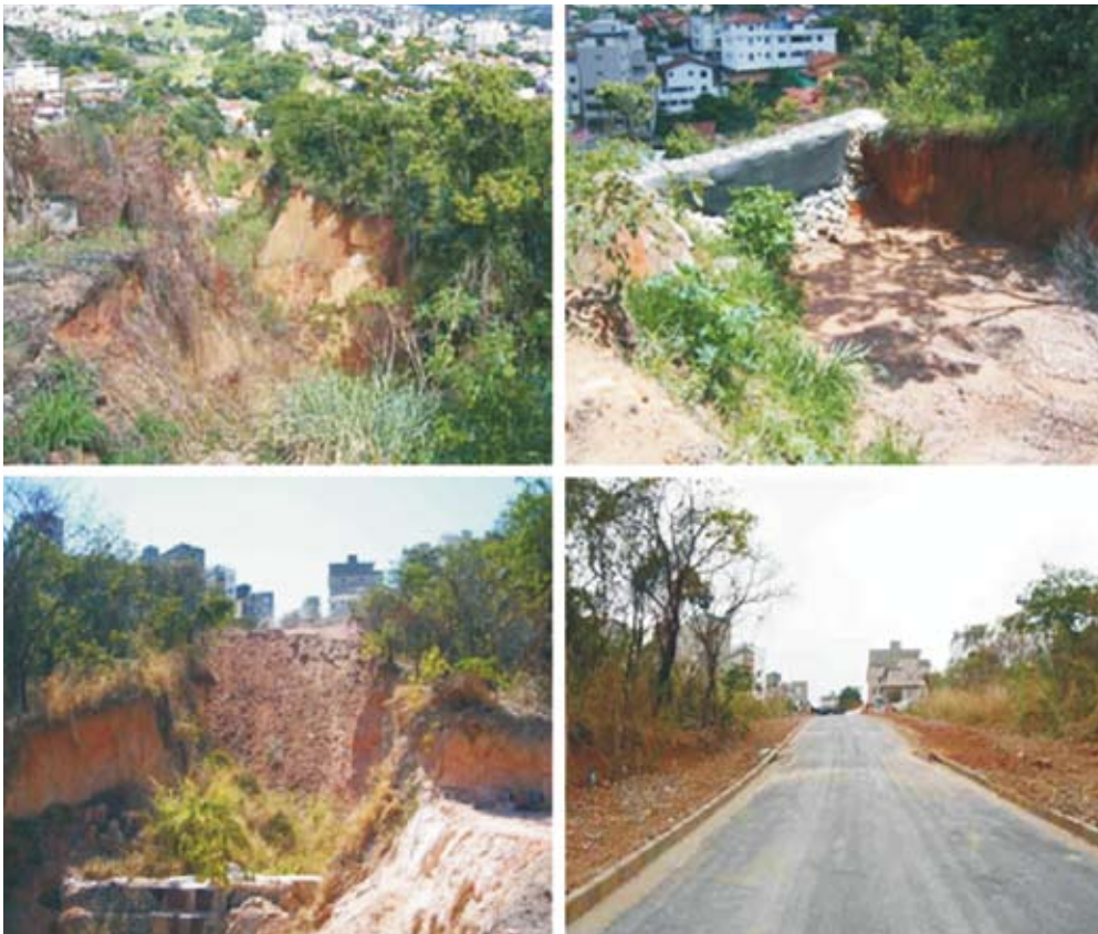
Figura 12. (Sentido horário a partir do topo): Erosão ravinosa com fundo seco, sensivelmente estabilizada na rua Sebastião Meneses, em Belo Horizonte. A operação iniciada pelo dique retentor seguida de enchimento com resíduos inertes e areia de desassoreamento da Lagoa da Pampulha proporcionou em menos de um ano a implantação da rua, que hoje já recebe edificações que aguardaram a possibilidade por mais de 30 anos.
