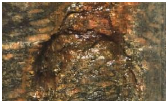
Foto 29 – Fratura apresentando evidências claras de percolação d'água. Fonte: Metrô-SP.
