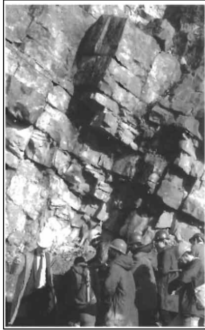
Figura 3- Exemplo de maciço rochoso com estrutura de descontinuidades paralelas e verticais. Fonte: Hudson & Harison (1997).
