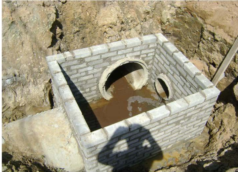
Figura 33: Exemplo de uma caixa de ligação ( http://www.jtbterraplenagem.com.br/obras.html ).
