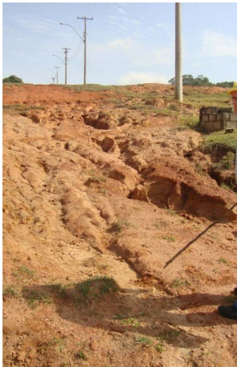
Figura 48: Trecho de uma das ruas do loteamento da Área 1 degradada por sulcos ravinas.
