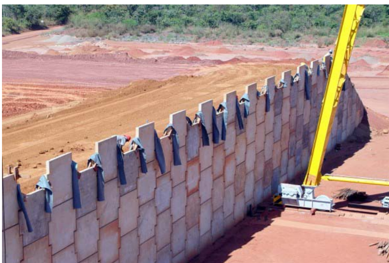
Figura 22: Aplicação de um muro de terra armada, enfatizando os elementos de cobertura ( http://www.terraarmada.com.br/projetos.php?ord=alfa&propg=8&x=753125&anc=1 ).
