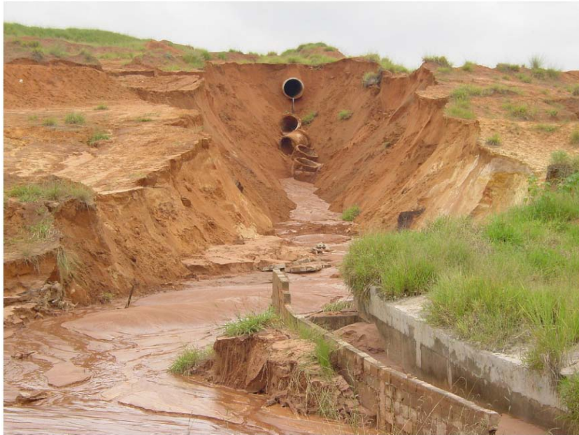
Figura 15: Voçoroca originada pelo rompimento de obras de drenagem pluvial associadas ao aterramento no município de São Pedro – SP (FERREIRA, 2004).
