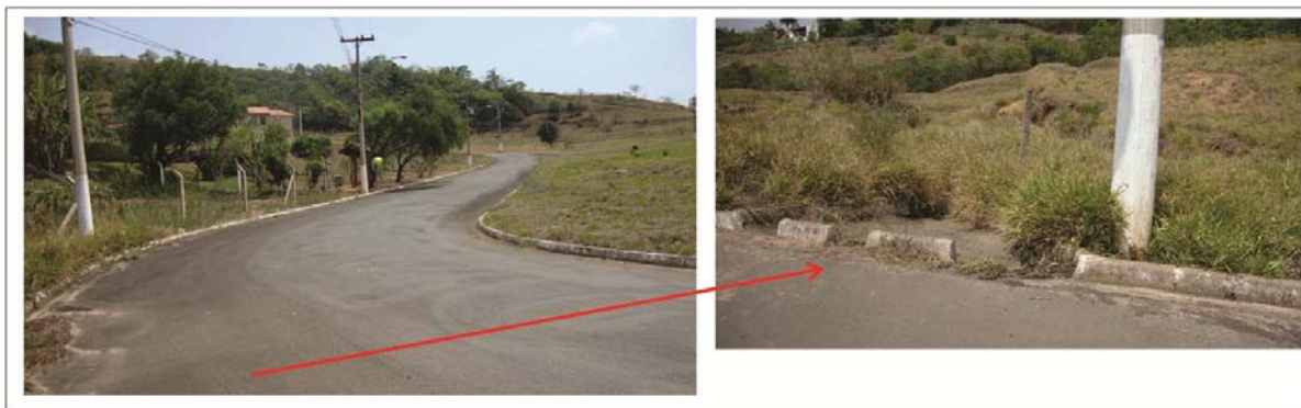
Figura 71: Via sem estruturas coletoras da água pluvial, com inclinação que favorece a concentração do escoamento, que é interceptado por uma canaleta que direciona o fluxo para uma área desocupada, próxima ao canal de drenagem.
