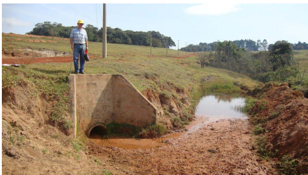
Figura 56: Cordão de nível construído na frente de uma saída de tubulação para evitar que o escoamento superficial acelere a erosão no local.
