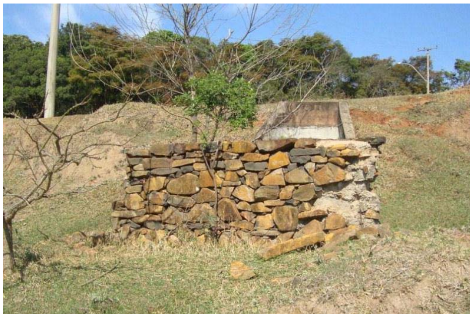
Figura 55: Muro de contenção posicionado na frente de uma saída de tubulação para contenção da velocidade do escoamento.
