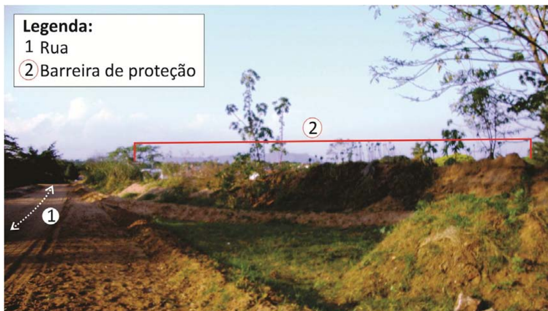
Figura 77: Barreira de proteção na forma de elevações de solo, dispostas ao redor da área, onde estão localizadas as feições erosivas da Área 3.
