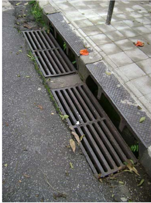
Figura 34: Exemplo de boca-de-lobo gradeada ( http://pt.wikipedia.org/wiki/Ficheiro:Boca_de_lobo.JPG ).
