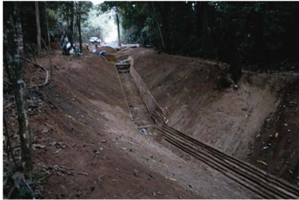
Figura 29: Retaludamento das paredes da voçoroca no entorno do canal principal da feição do Jardim Botânico de Goiânia – GO (SPONGA e COELHO, 2001).
