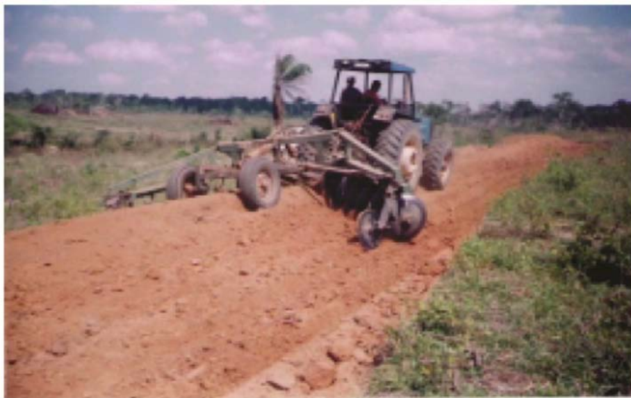
Figura 10: Terraço tipo Mangum, de base média, construído com terraceador, Acrelândia - Acre (EMBRAPA, 2004).
