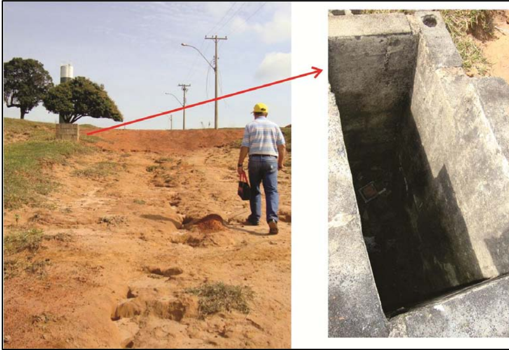
Figura 53: Caixa de Passagem próxima a uma das ruas para redirecionamento da água de escoamento superficial.
