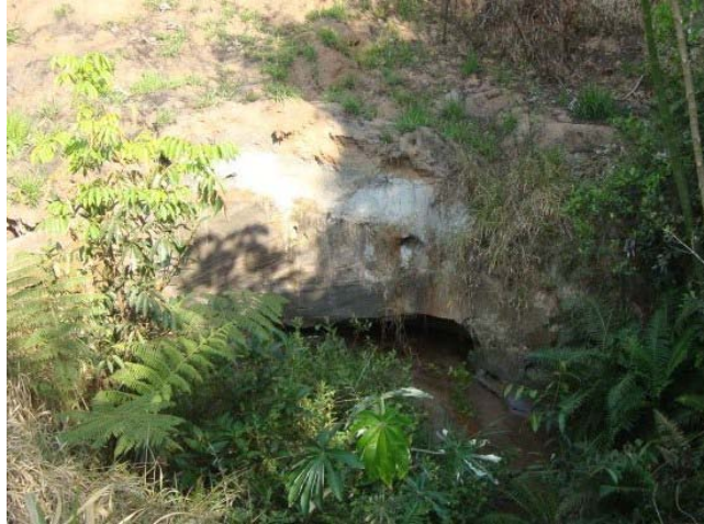
Figura 64: Detalhe para o processo de piping e a presença de água no interior da feição F15.
