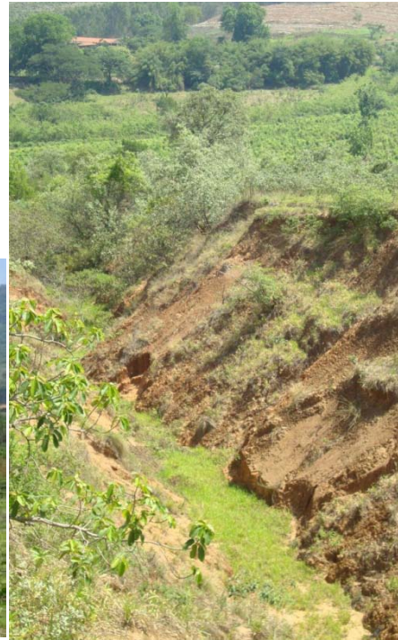
Figura 83: Ramificação da F1 com presença de água no interior.
