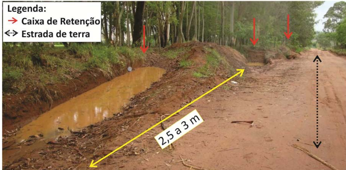
Figura 13: Caixas de Infiltração ou Retenção dispostas ao longo de uma estrada de terra no município de Brotas – SP.
