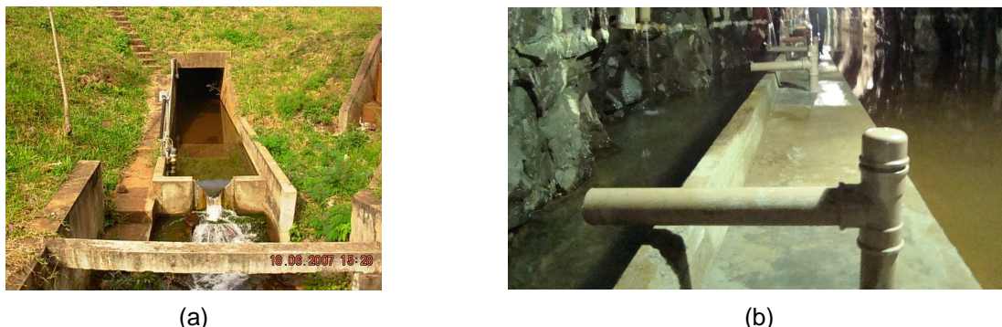
Figura 4 – Sistema de controle de infiltrações pela fundação. (a) Medidor de vazão do tipo triangular externo. (b) Drenos de fundação e canaletas de drenagem localizados em túnel de drenagem.
