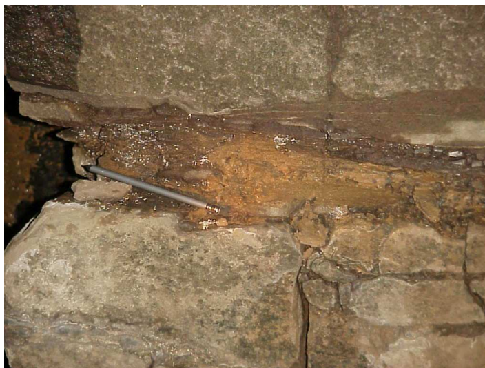
Figura 48 – Descontinuidade B localizada no túnel de exploração e drenagem (cota 61 m) executado a margem esquerda do rio Paraná – presença de argila e fragmentos de rocha.
