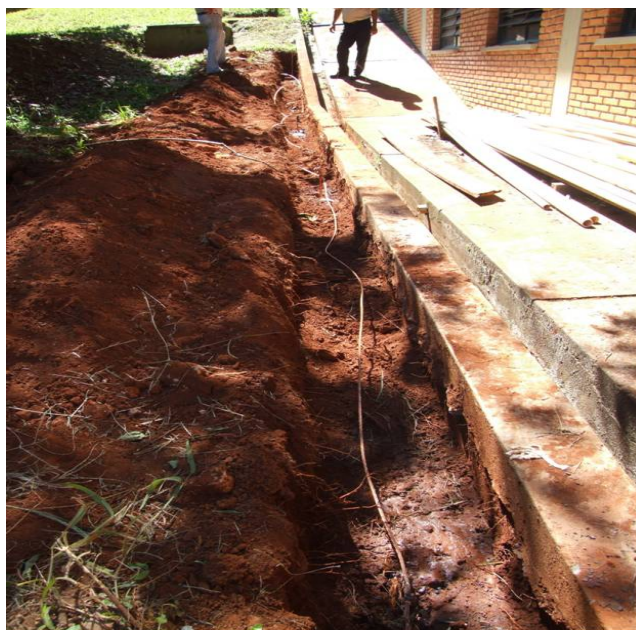
Figura 3.33 Vala escavada para implantação do fio e barras metálicas de cobre para aterramento
