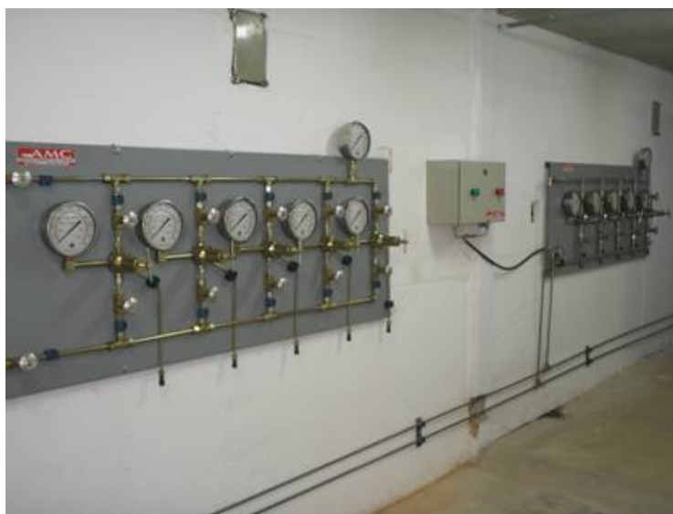
Figura 3.28 Painéis reguladores de carga
