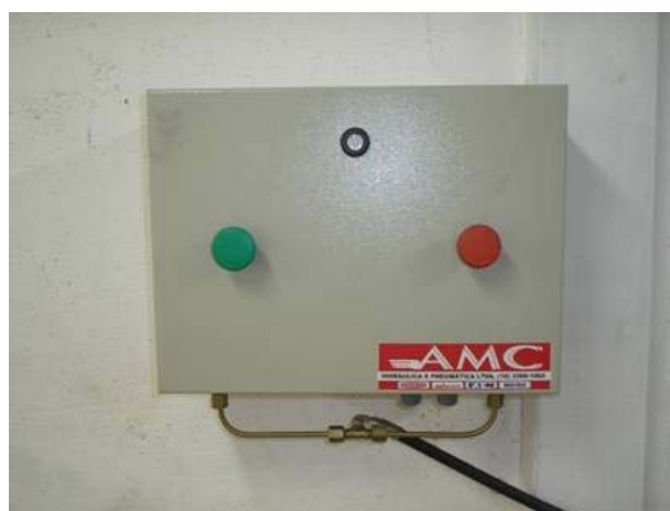
Figura 3.27 Painel de controle dentro da qual se encontra o pressostato
