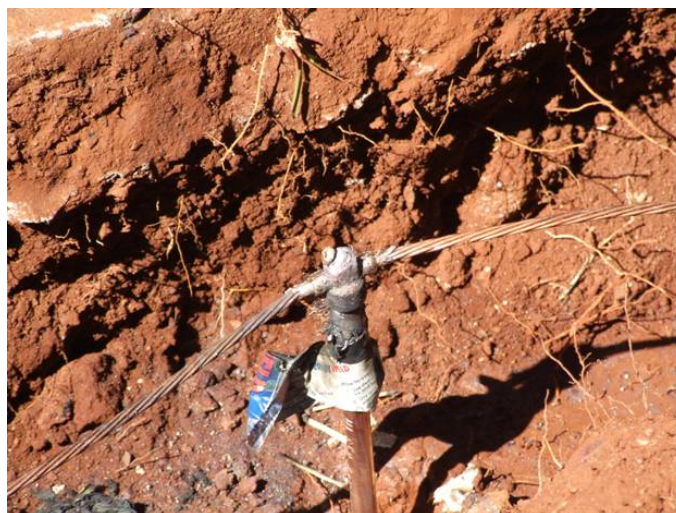
Figura 3.35 Detalhe da cabeça da haste de cobre interligada com o cabo de cobre
