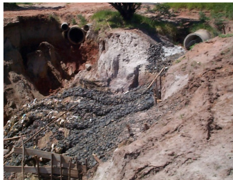
Figura 25. Gabião destruído pela ação da água em 2003 (Corgi & Giacheti, 2005)
