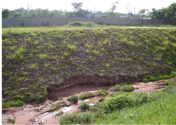
Figura 29. Assoreamento do canal e erosão do talude no final de 2005
