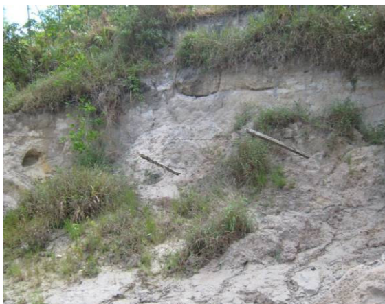
Figura 86. Escorregamento em fatias devido ao fluxo de água na base do talude no local de coleta da amostra 1
