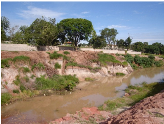
Figura 32. Escorregamento no local de afloramento de água em 2005
