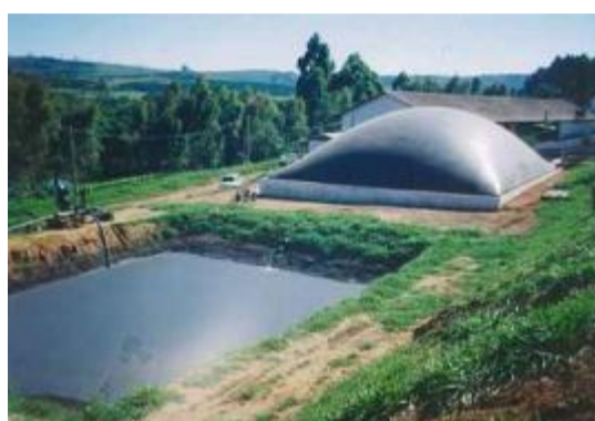
(f) Biodigestores de gás
