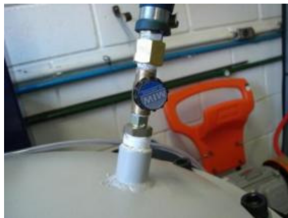
(b) Registro para controle da pressão
