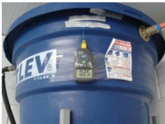
(a) Reservatório e monitoramento da temperatura
