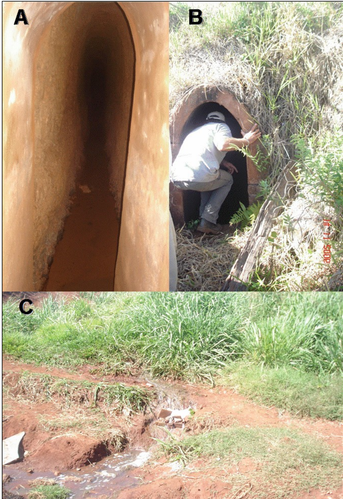
Figura 5.4: A e B) Entrada da galeria construída sobre a nascente (N7), que conduz a água para o Córrego Santa Cruz. C) Sujeira e vazamento de galeria pluvial sobre a nascente do Córrego Bom Retiro (N1).
