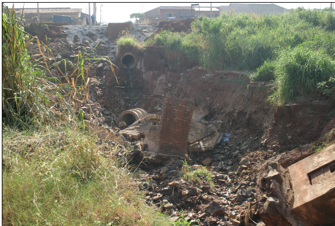
Figura 5.13: Fotografia de escorregamento no Jardim Padre Augusto Sani, microbacia do córrego Barra Mansa (Cedida pela Defesa Civil de Jaú).
