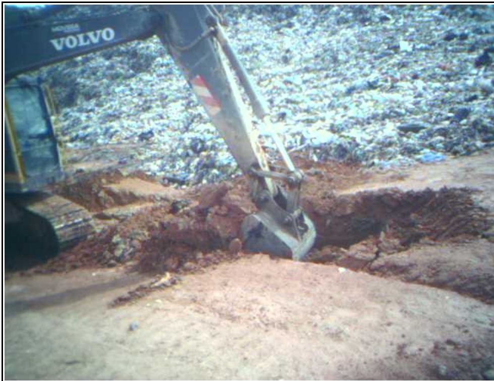
Figura 3.5. Escavação do solo de cobertura para a retirada de material com 4 anos de aterrado.
