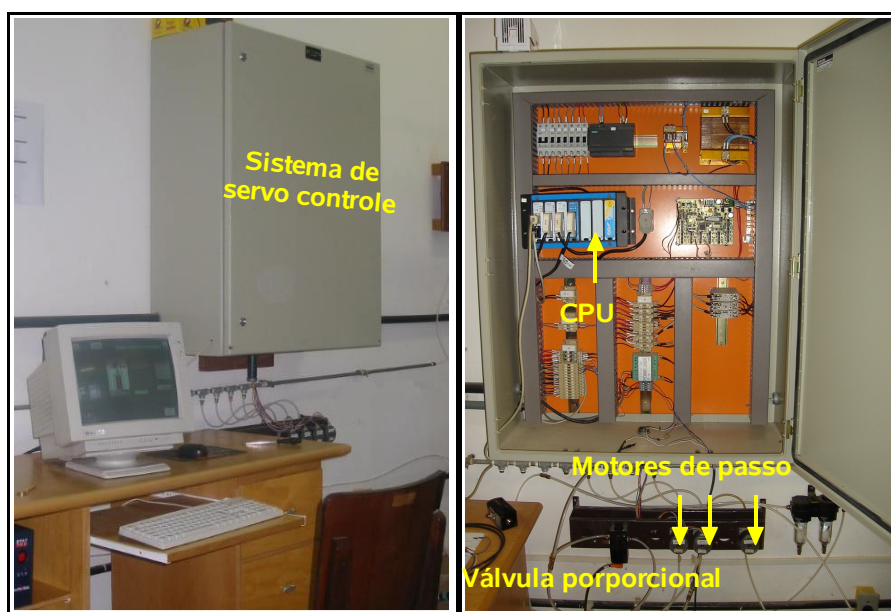
Figura 3.10. Sistema de aquisição de dados e servo controle utilizado para a realização de ensaios triaxiais e de compressão confinada em amostras de grandes dimensões.
