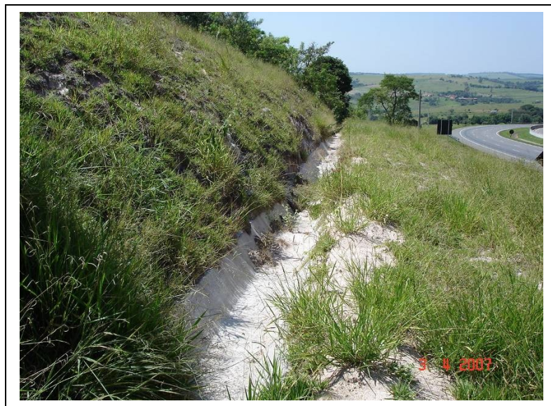
Figura 31: Canaleta de crista de talude revestida e assoreada. Pto 10/ seção 10.
