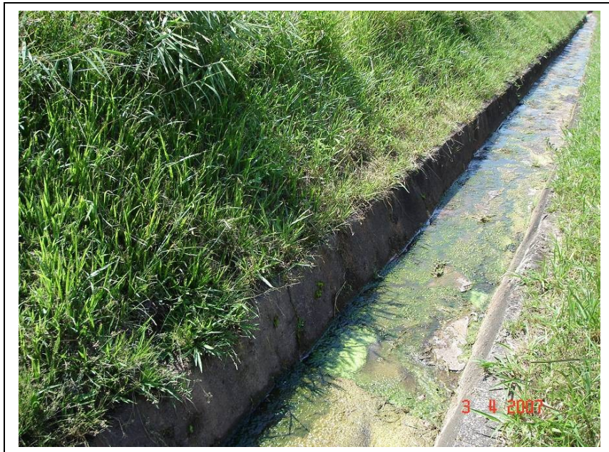
Figura 38: Canaleta de drenagem revestida com saturação de água
