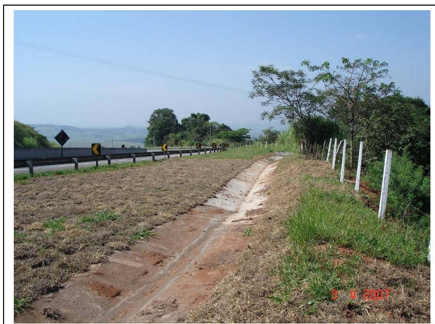
Figura 37: Canaleta revestida com redutor de energia
