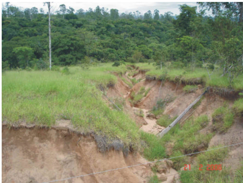
Figura 7.18. Ravina causada por deficiência no sistema de drenagem da estrada que liga Analândia a Corumbataí (Ponto 12).
