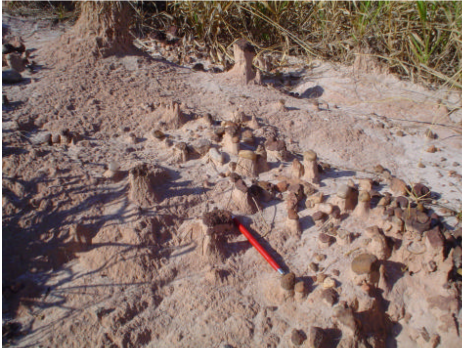
Figura 7.16. Evidência de erosão laminar em área de solo exposto (Ponto 100).
