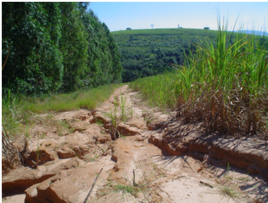
Figura 7.17. Erosão laminar e em sulcos nas estradas das áreas plantadas com cana-de-açúcar, por falta de manutenção durante o ano (Ponto 56).
