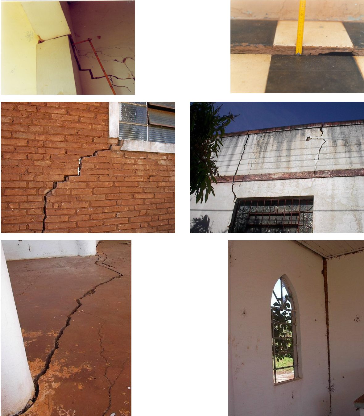
Fig. 4.27. Avarias de construções localizadas às margens do lago de Três Irmãos (parte 1).
