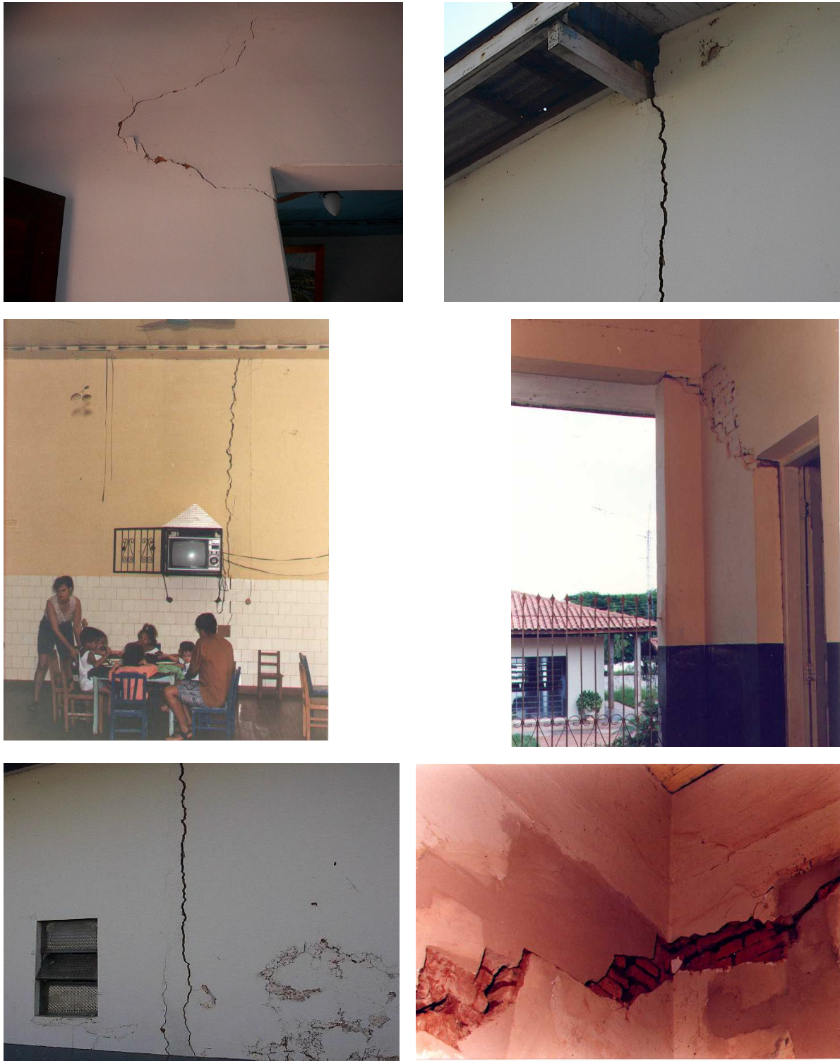
Fig. 4.28. Avarias de construções localizadas às margens do lago de Três Irmãos (parte 2).
