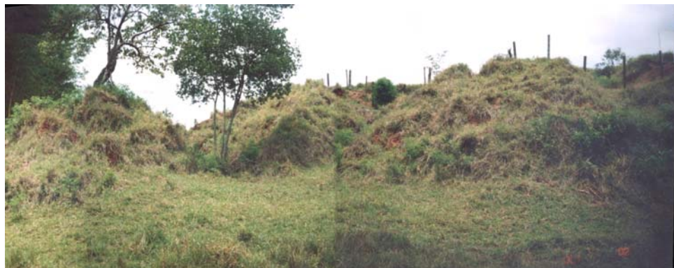
FIGURA 40 - Feição erosiva controlada próxima ao aeroporto (Ponto 39).
