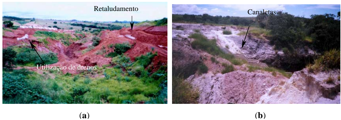
FIGURA 46 - (a) Medidas de controle para minimizar o progresso da feição B, retaludamento e colocação de drenos (Dez/2001); (b) construção de canaletas para o escoamento das águas pluviais (jan/2003).
