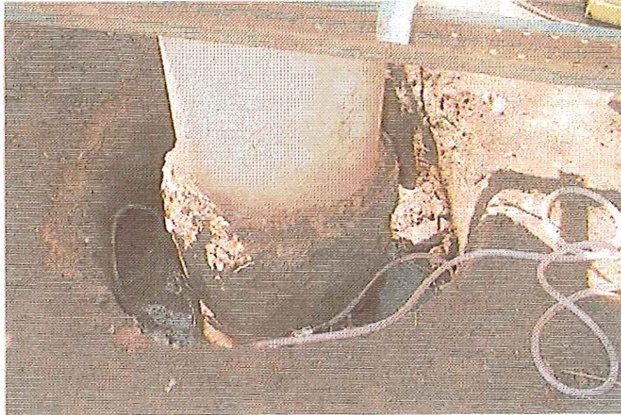
FIGURA 6.1: Cava Aberta no Terreno, ao redor do tubulão, para Realização do Ensaio Inundado.
