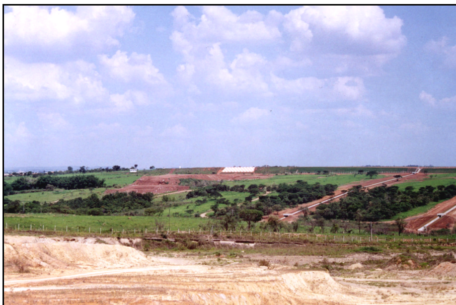
Figura 76: Obras de retaludamento do terreno na cabeceira da pista do aeroporto internacional de Viracopos, Campinas. Notar o sistema de canaletas instalado, o qual redireciona o escoamento das águas superficiais nesse trecho.
