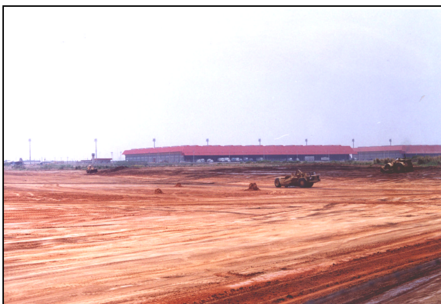
Figura 75: Movimentação de terra para obras de ampliação do aeroporto internacional de Viracopos, Campinas.
