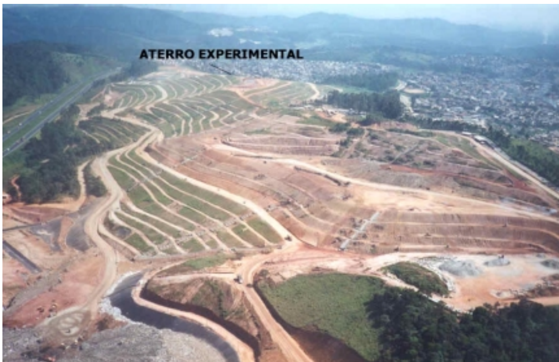
Figura 3.1 - Vista aérea do Aterro Sanitário Bandeirantes com a localização do aterro experimental
