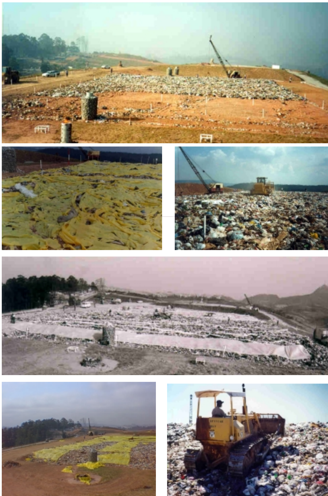
Figura 3.5.3 – Compactação dos resíduos nas praças de trabalho em planos horizontais e inclinados
