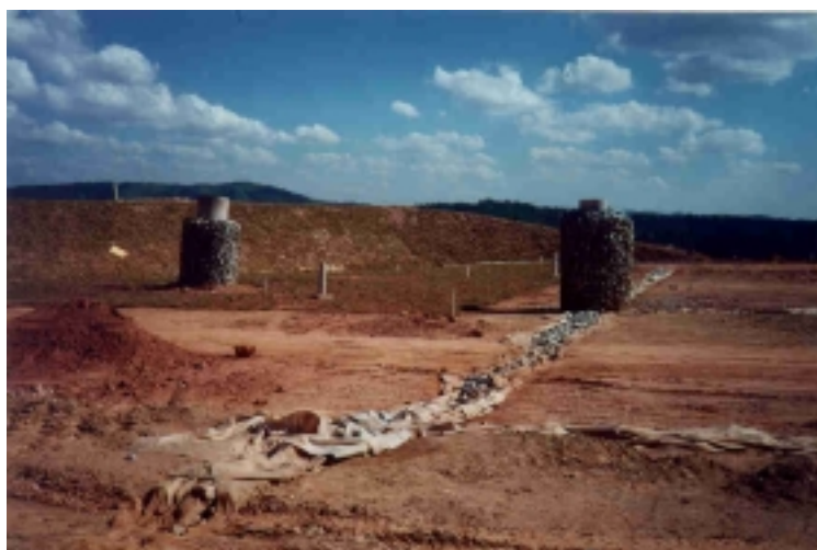
Figura 3.2.8 – Detalhe do sistema de drenagem de gases e líquidos percolados.
