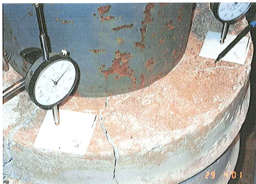
FIGURA 5.11 : Vista do Tubulão com Ruptura.
