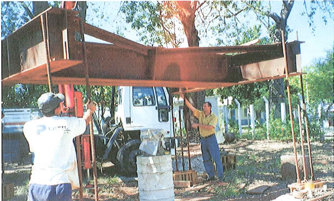
FIGURA 5.2 : Viga de Reação.
