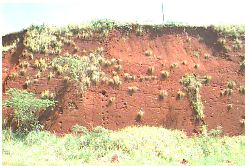
FIGURA 3.5- Detalhe de um escorregamento superficial.
