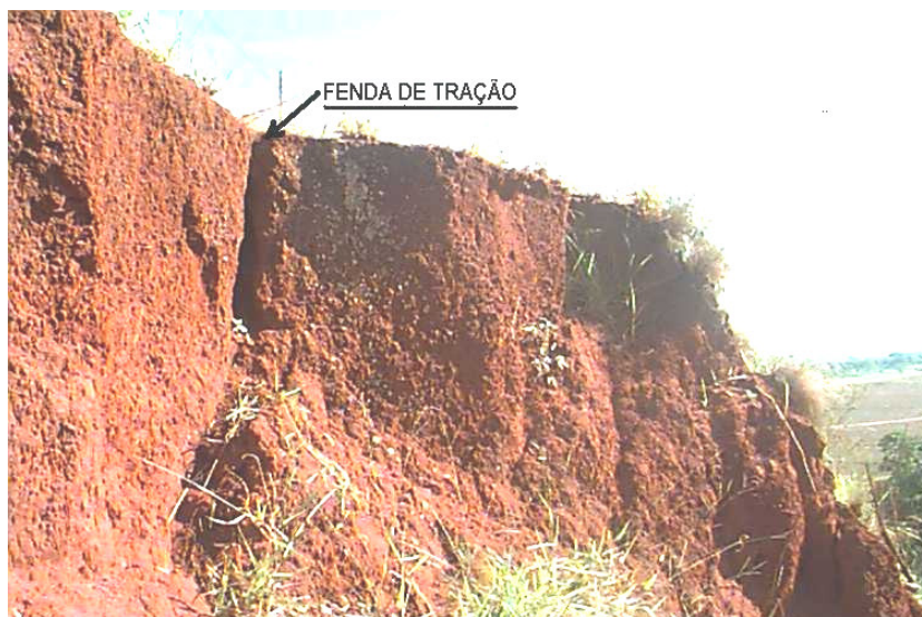
FIGURA 3.4- Detalhe da fenda encontrada em campo.
