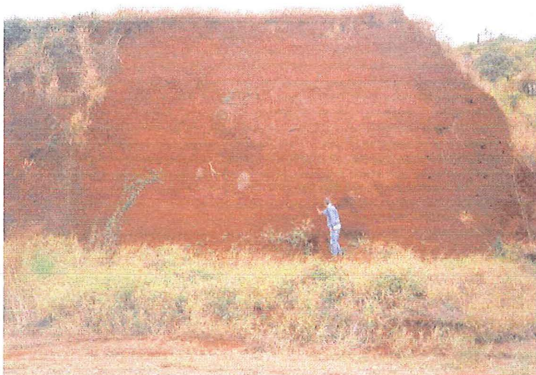
FIGURA 52. Talude coluvionar, ponto LM 07.
