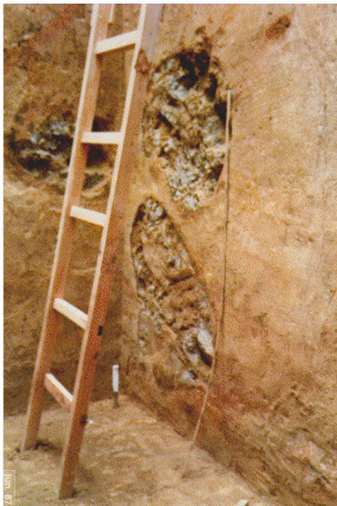
FIGURA 55 – Ocorrência de matacões alterados, ou núcleos de rocha alterada, nas paredes do poço E2. O piso do poço está na cota 646,25 m, confirmando a existência de matacões acima da cota 645 m.
