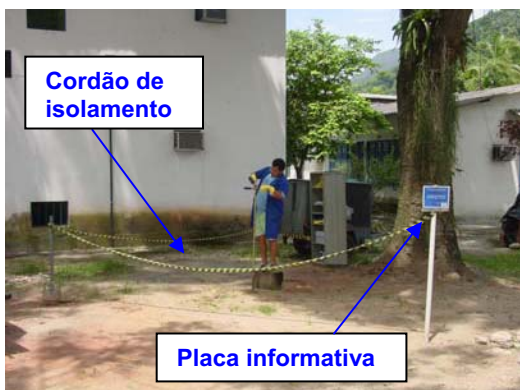
Figura 4.19 – Execução dos furos a trado, para instalação do bastonete e das sondas (vista geral)
