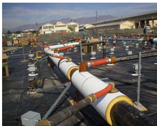
Figura 2.23 – Tubulação de gases do sistema (TerraTherm Inc.)
