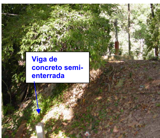
Figura 4.5 – Vista da face do talude, mostrando pedaços de vigas surgindo do solo
