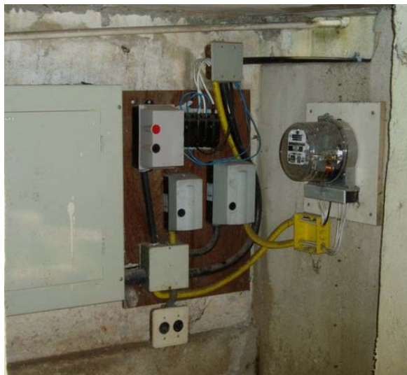
Figura 3.23 – Instalação elétrica do LGMA/PUC-Rio , com medidor de consumo individualizado para os sistemas de dessorção térmica
