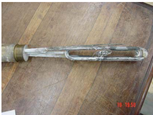
Figura 4.81 – Cartucho de resistência danificado (1)
