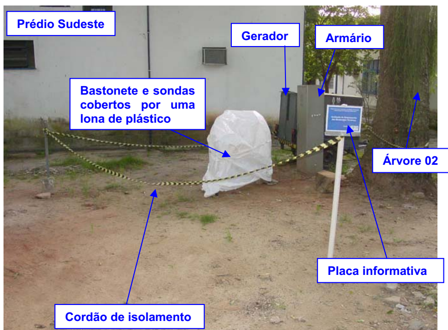
Figura 4.25 – SDTIS instalado na EMBRAPA Solos , vista geral
