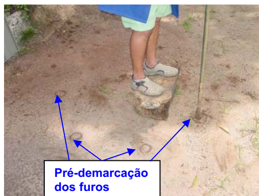
Figura 4.20 – Execução dos furos a trado, com locação pré-determinada, para instalação do bastonete e das sondas (vista aproximada)
