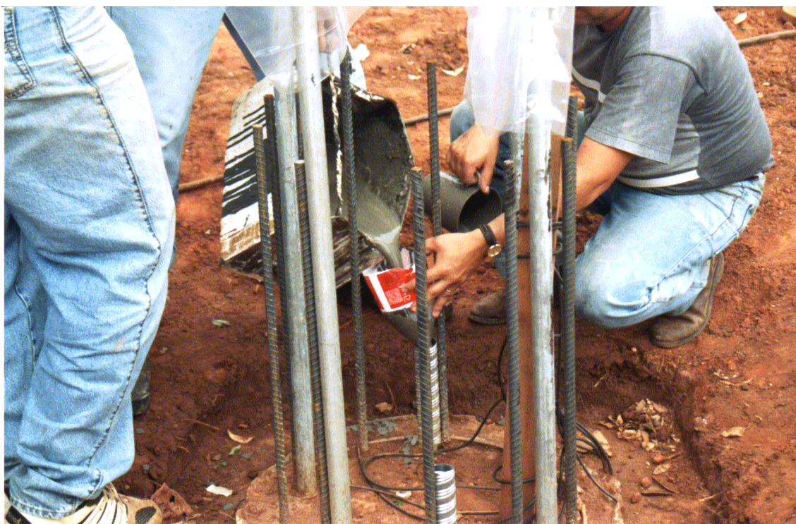
Foto 04. Lançamento da nata de cimento para instalação das linhas de strain-gages, segundo procedimento utilizado pelo IPT.
