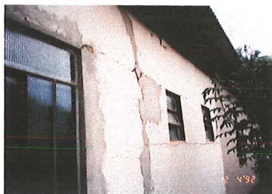
FIGURA 77 - Aparecimento de trincas após a ocorrência de colapsos, confirmando o processo de subsidência.
