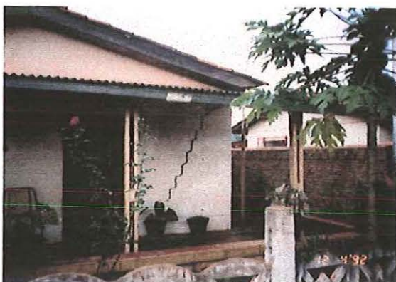
FIGURA 76- Exemplos de trincas nas edificações afetadas por colapso.
