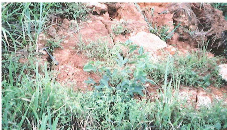
FIGURA 75 - Colapsos tipo classe 3.
