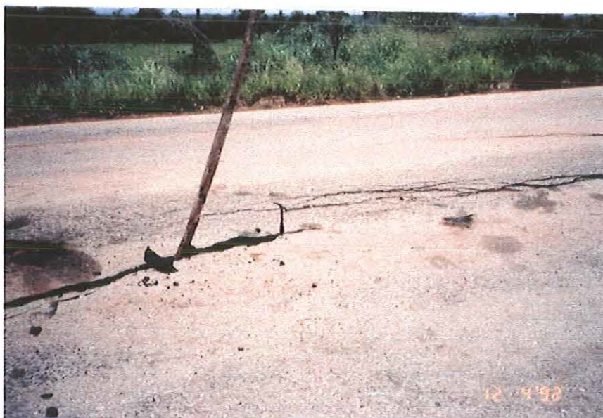
FIGURA 78 - Fendas provocadas por colapso - leito da BR 163/364.
