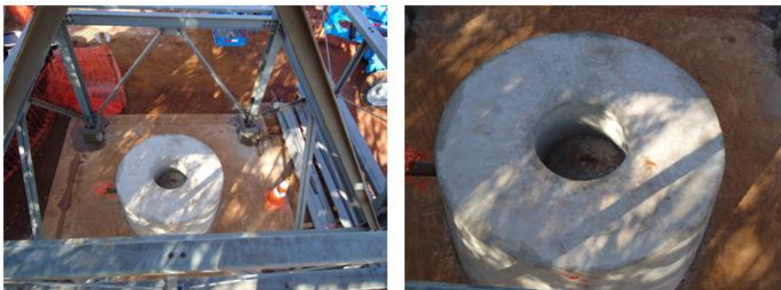
Figura 34. Posicionamento do bloco de base na torre, à esquerda e à direita, com detalhe do furo no centro do bloco por onde descera a ferramenta de perfilagem gama-gama.
