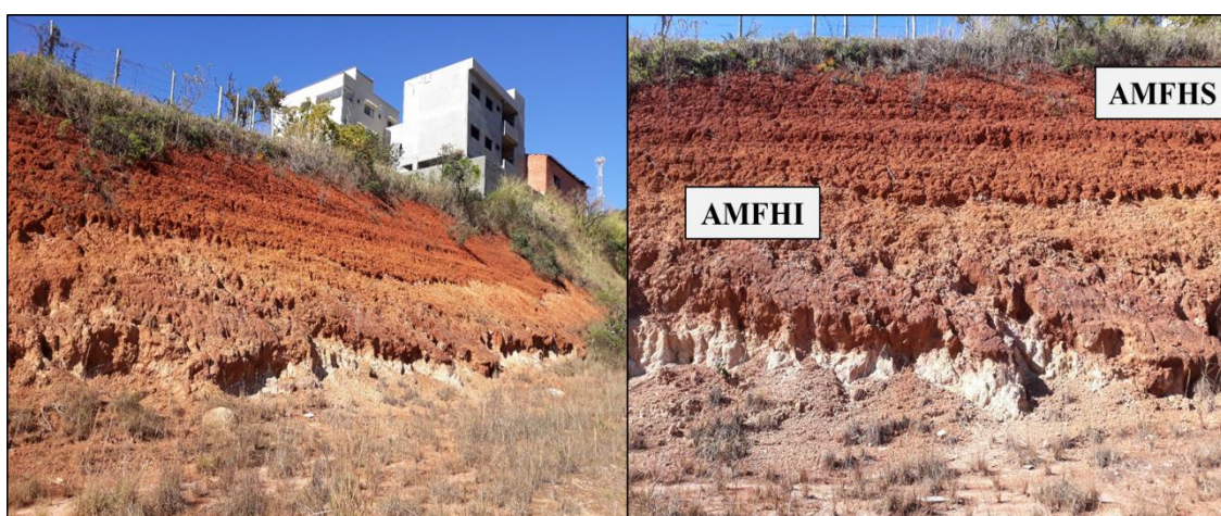
Figura 3.20 – Talude localizado na Avenida Maria Firmino, Ouro Branco-MG (AMF).
