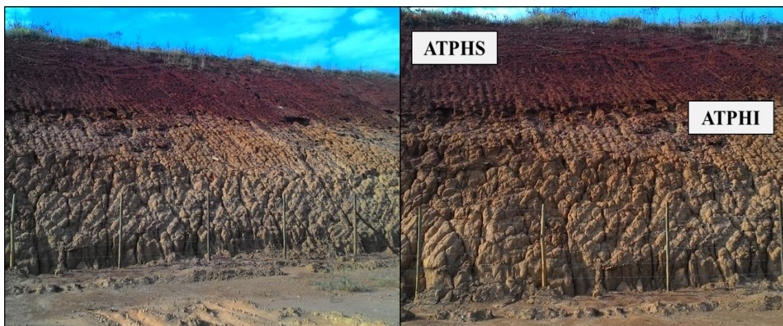
Figura 3.16 – Talude localizado no distrito de Antônio Pereira (ATP).
