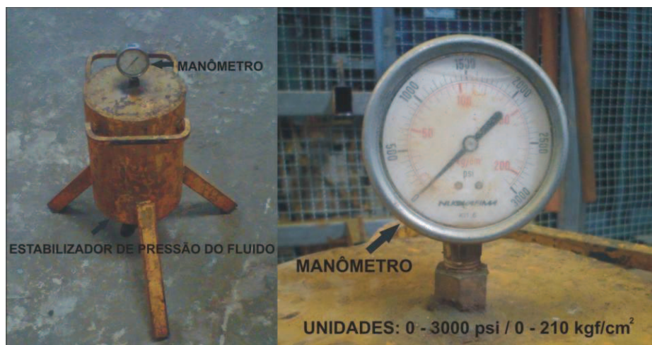
Figura 3. 18: Estabilizador de pressão do fluido e manômetro medidor de pressão.
