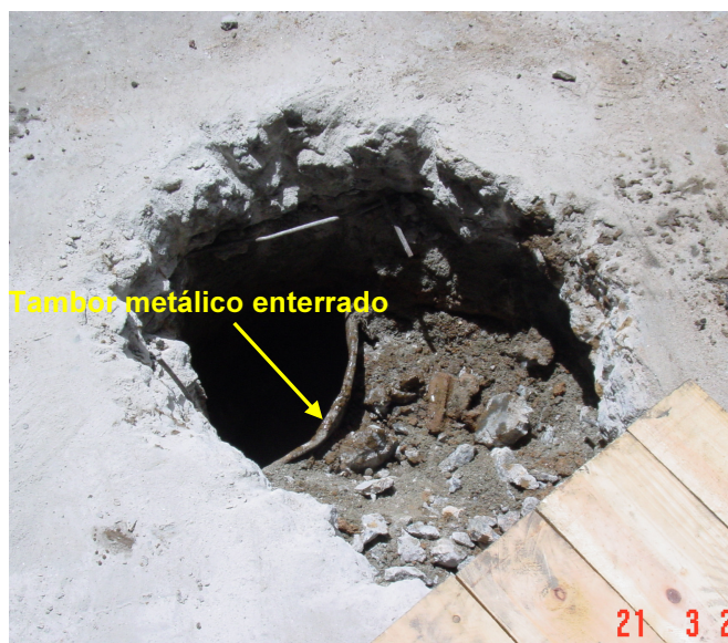
Figura 4.14 – Tambor metálico enterrado no subsolo
