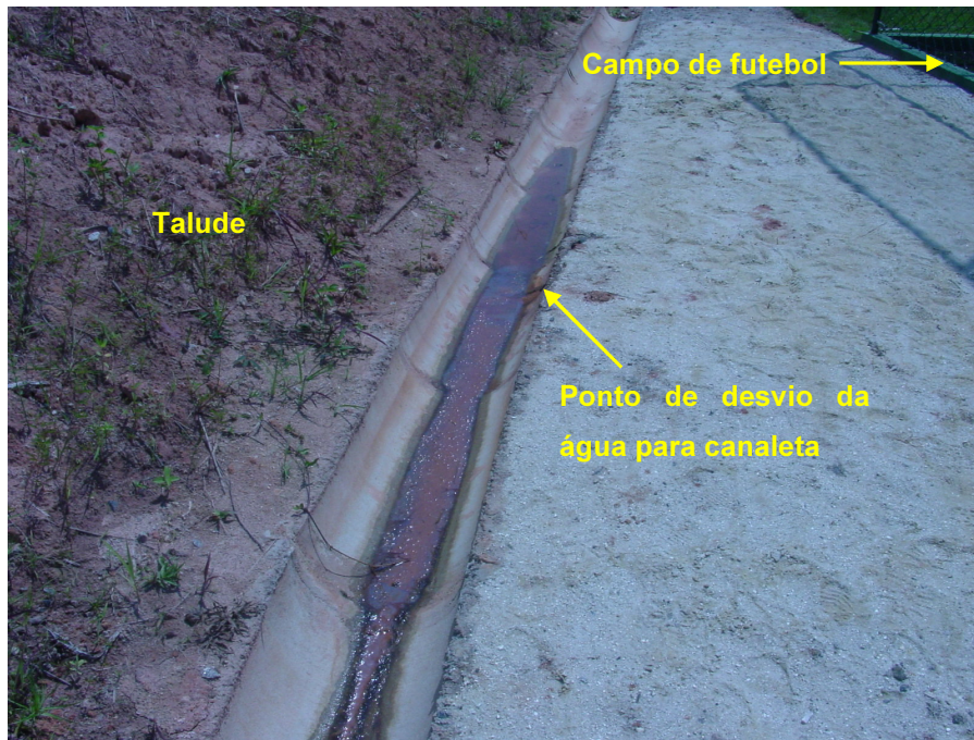
Figura 6.3 – Surgência de água na área de lazer
