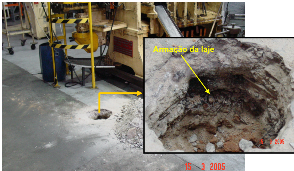
Figura 4.17 – Localização da 3ª aquisição com detalhe da ferragem aparente no furo
