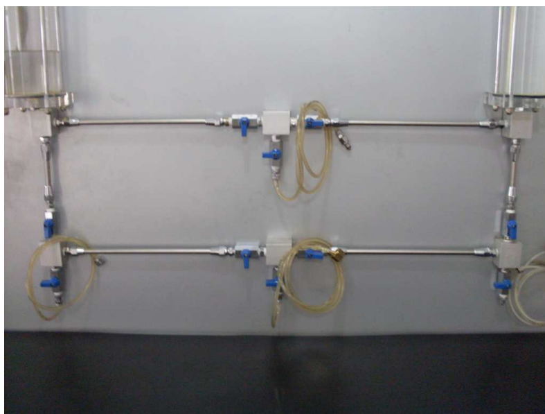
Figura 4.3 – Sistemas de interligação do painel da montagem do Ensaio HCT - M
