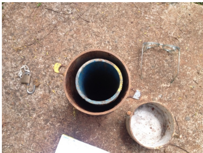
Figura 5.1 – Parte externa do poço, no qual foram realizadas as perfilagens geofísicas. Terminação em base de concreto com revestimento metálico nos primeiros 10 metros, protegendo o revestimento de PVC que continua ao longo do pacote sedimentar.
