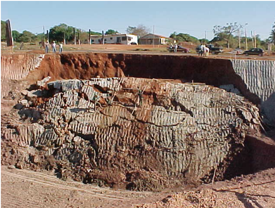
Figura 6 - Deslizamento entre as estacas km 229 + 24 a 229 +060 LD
