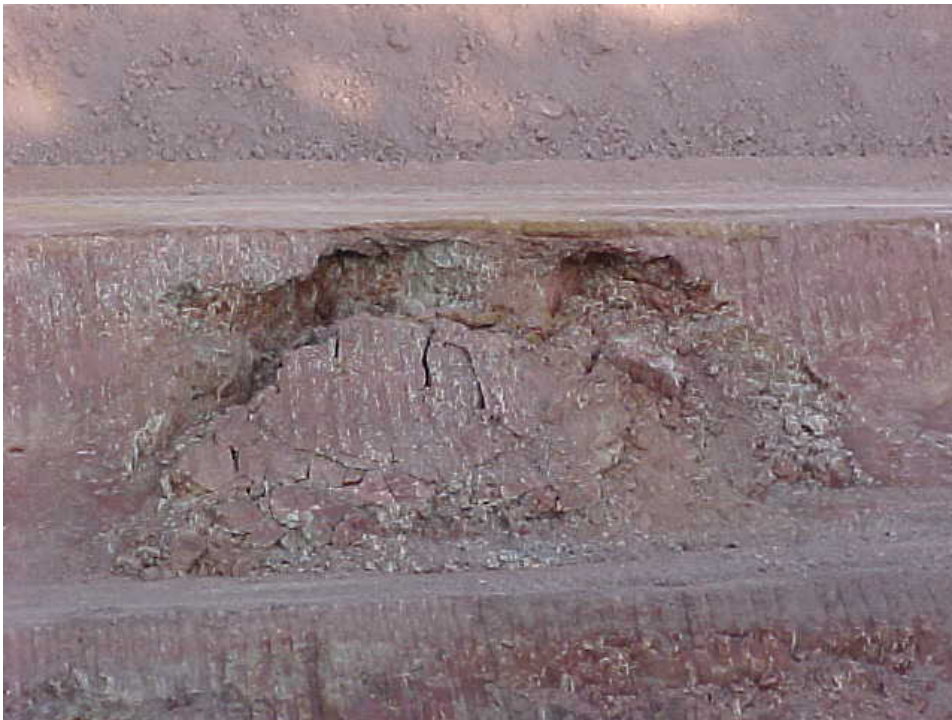
Figura 7 - Deslizamento, estaca km 229+ 120 LE.
