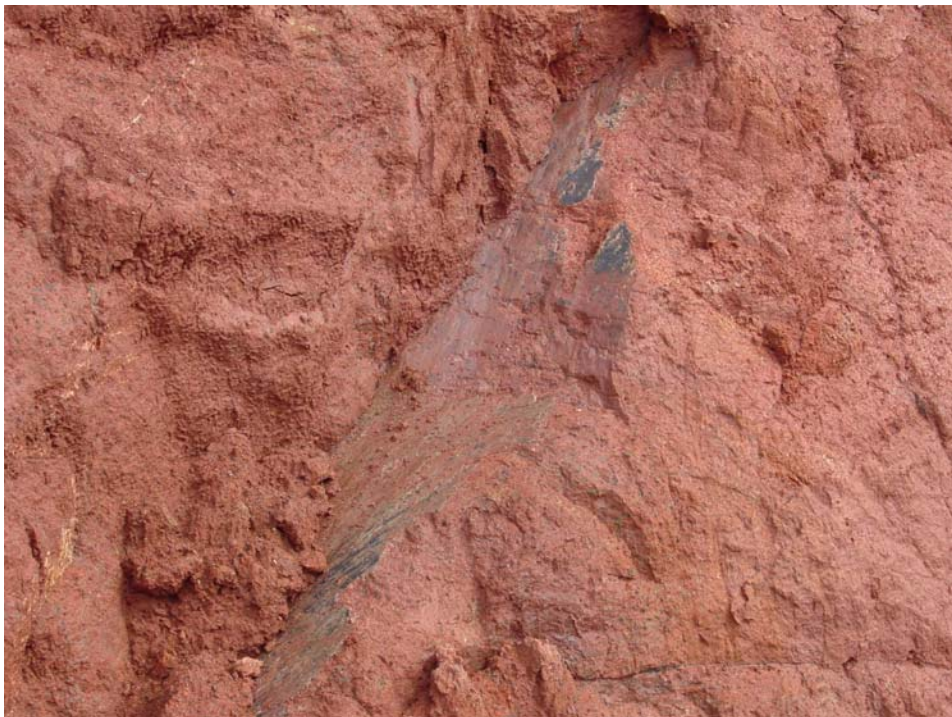
Figura 8 – Fratura inclinada apresentando estrias de fricção no talude de solo residual.
