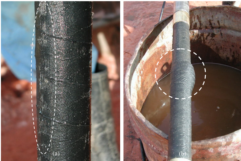
Figura 101 – Fotos de danos à membrana: (a) dano superficial na camada de reforço; (b) membrana com ruptura localizada.
