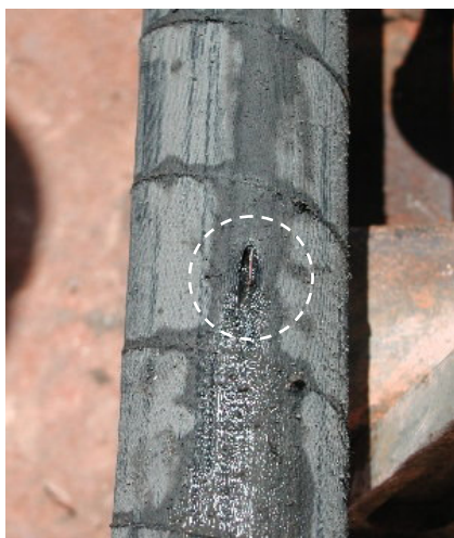
Figura 96 – Detalhe de perfuração da membrana ocorrida durante a expansão no PTM2
