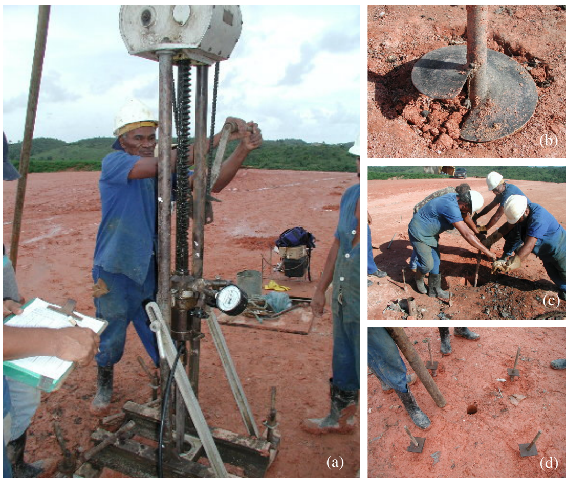
Figura 91 – Sistema de cravação do PMT usado no aterro da Muribeca: (a) cravador; (b) trado de reação; (c) fixação das reações; (d) trados fixados.
