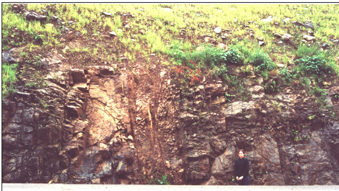
Figura 4.23 Talude do D8 com zona de falha E-W.
