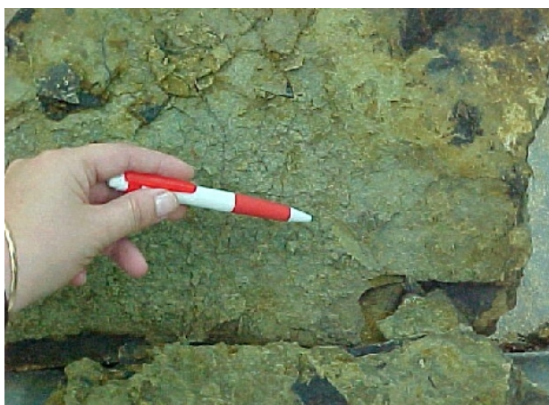
Figura 5.38 Detalhe mostrando slikensides e grooves após a ruptura.
