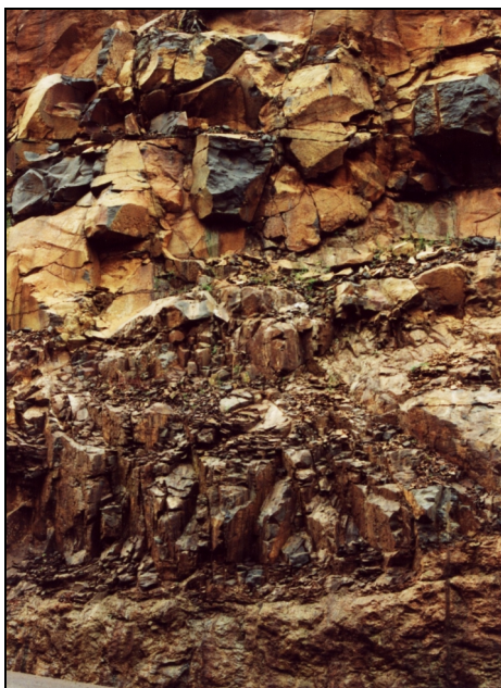
Figura 4.21 Talude do D7, com blocos instáveis em sua porção superior.
