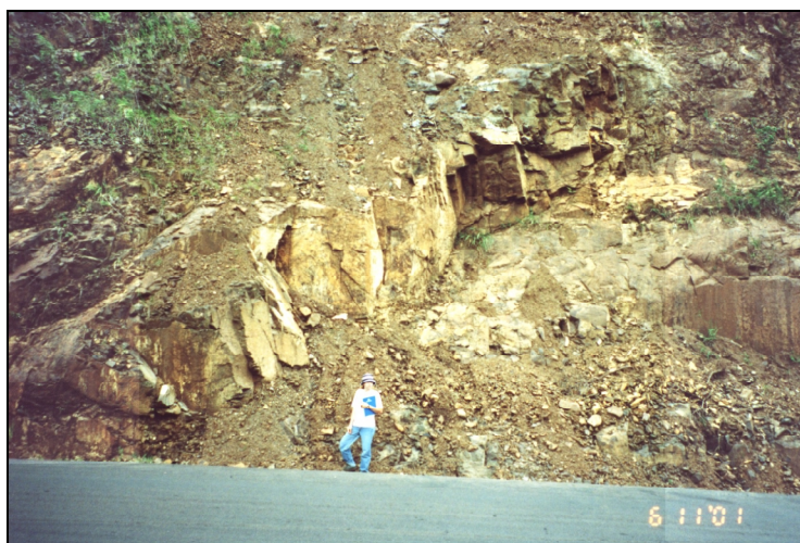
Figura 6.9 Escorregamento planar associado em talude e corte.
