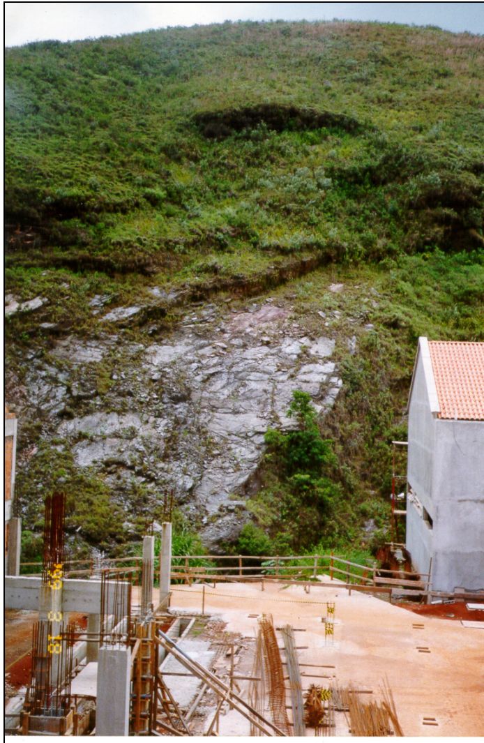
Figura 3.1. Cicatrizes de instabilidades identificadas na encosta do Morro do Curral.
