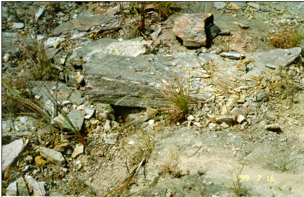
Figura 8.11. Tombamento de blocos em taludes de xisto no agrupamento I
