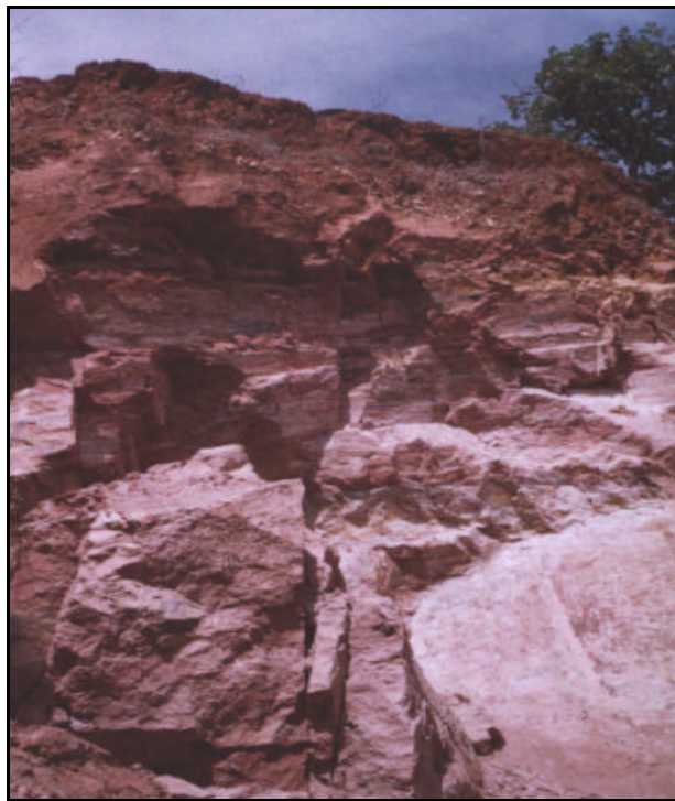
Figura 4.10 – Fraturas de alívio sub-horizontais / verticais a sub-verticais (Parede esquerda da Erosão I)
