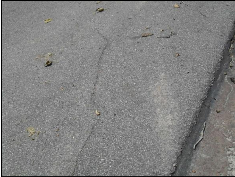
Figura 4.18 Rachaduras aos 110NE da área PX.
