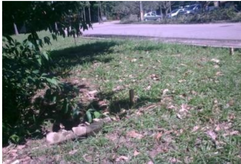
B – Erosão próximo a 60NE a 3 m da pista.
