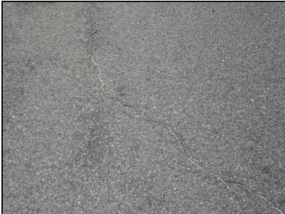
Figura 4.19 Rachaduras aos 112 NE da área PX relacionado à presença de tubulação abaixo do asfalto.
