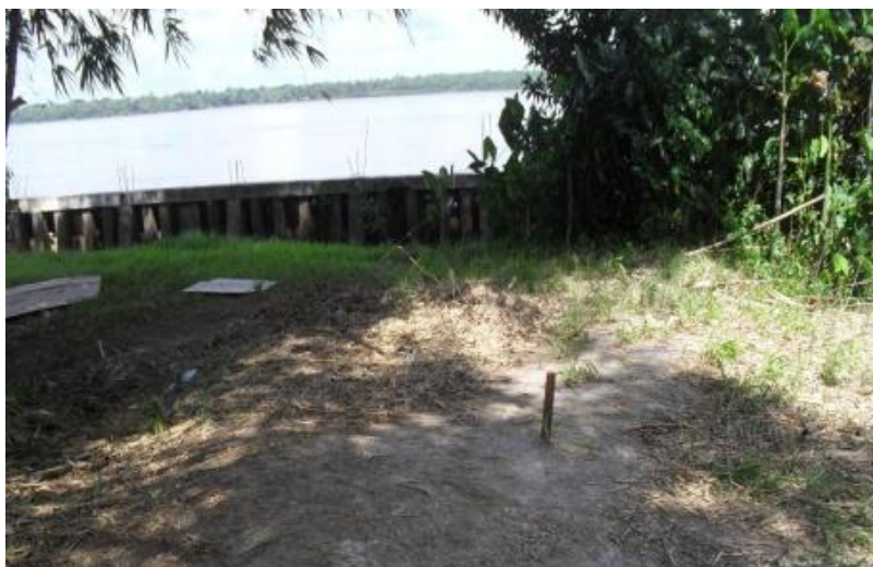
H – Declínio da erosão, com reinício do muro de contenção de 205 a 260NE, a 3,5 m da pista.
