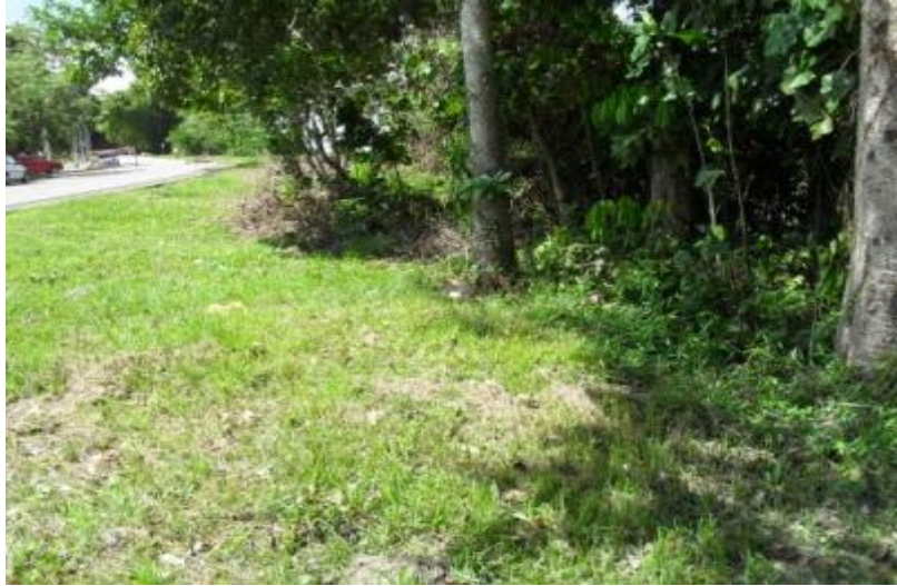
A – Erosão distante da pista (8 m) entre 0 e 35NE.
