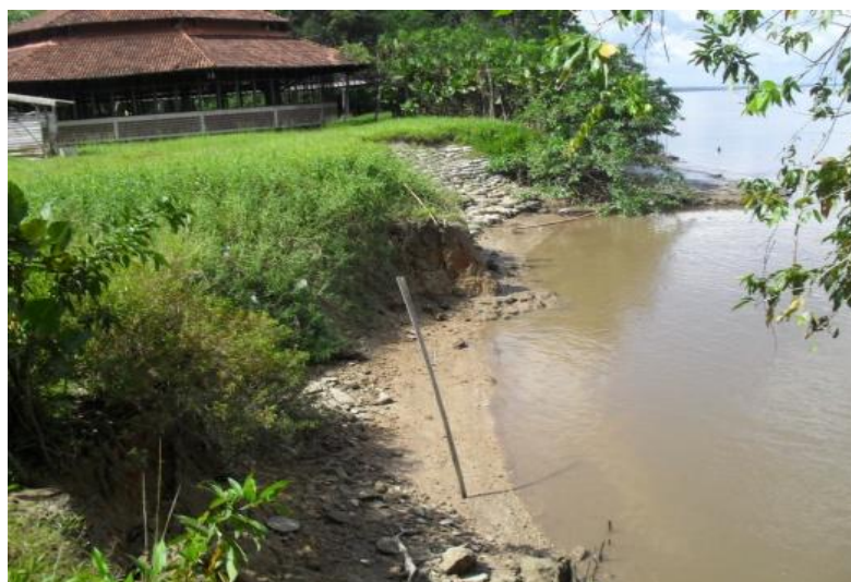
X – Região erodida de 585 a 610NE a 4,3 m da pista, com contenção.
