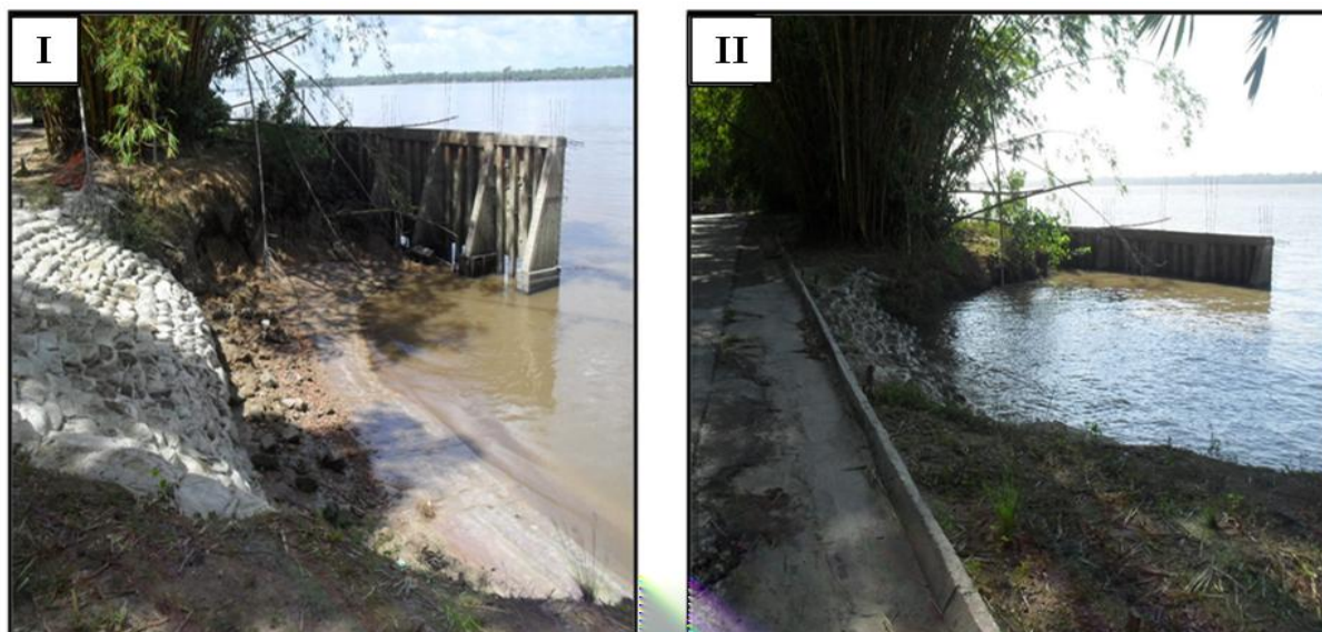
R – Região erodida de 440 – 460NE, em: (I) maré baixa e (II) maré alta. A pista foi reconstruída após o seu desmoronamento e acrescentados sacos de cimento para contenção da erosão. Reinício do muro de contenção aos 460NE
