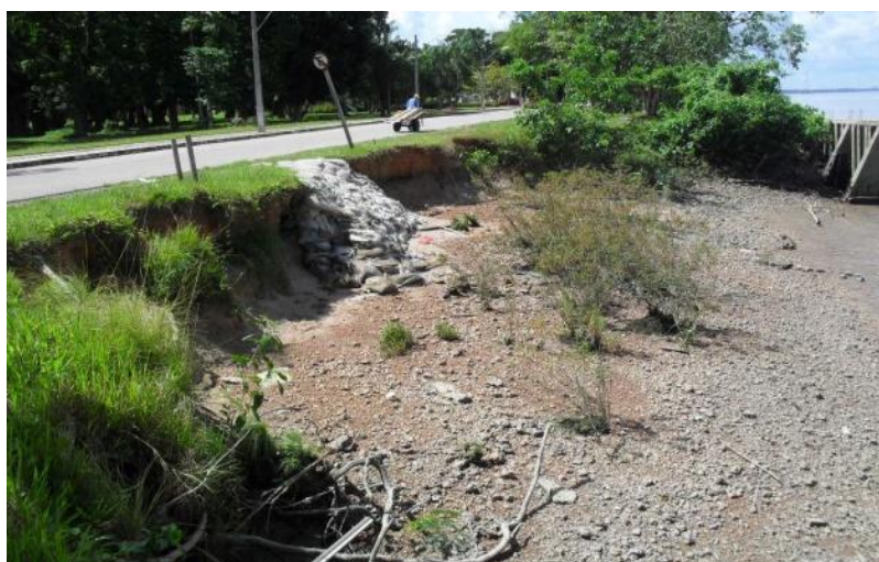
E – Erosão rente à pista, entre 110 e 145NE, com sacos de cimento entre 117 e 124NE.
