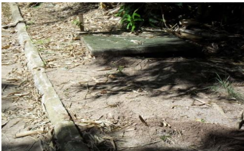
P – Tapa de fossa com tubulação saindo do bambuzal em 390NE.
