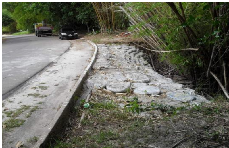
U – Região erodida 520 a 550NE, com sacos de cimento a 1 m da pista.
