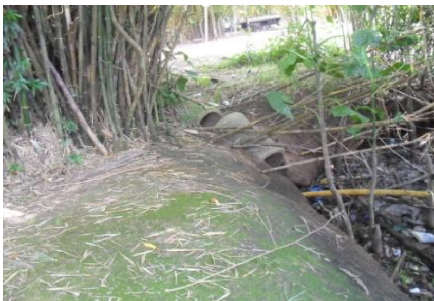
N – Bambuzal aos 300NE com tubulação de esgoto passando ao lado, desagregando e provocando erosão, distante a 1m da pista.
