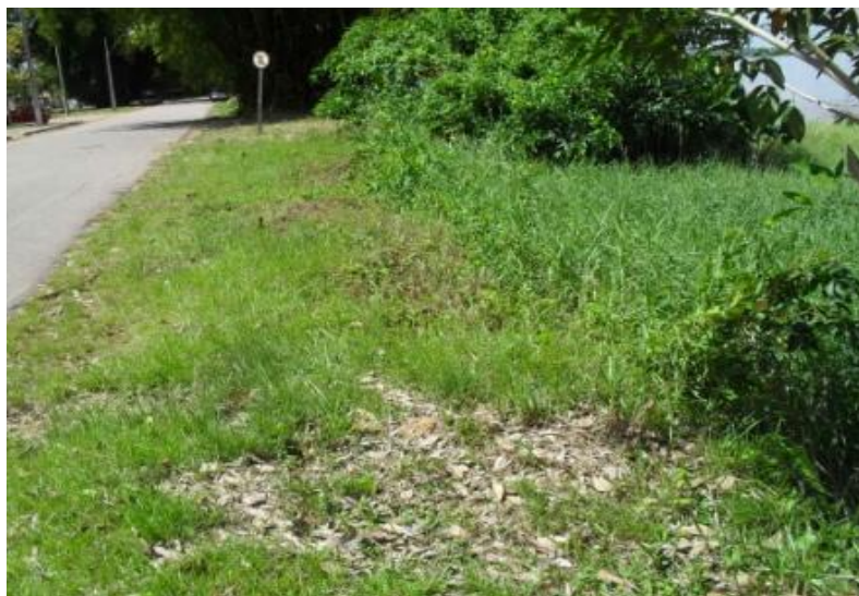
G – Erosão de 170 a 205NE (com queda do muro de contenção), distante 2 m da pista.
