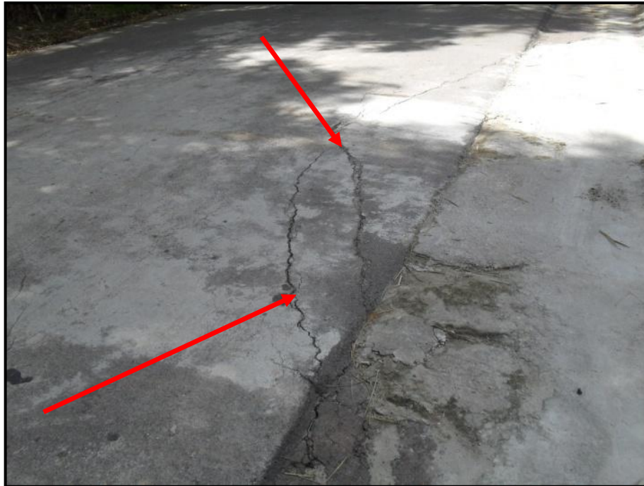
Figura 4.20 Rachaduras no formato de meia lua no pavimento asfáltico na área PY, 440 – 460 NE.
